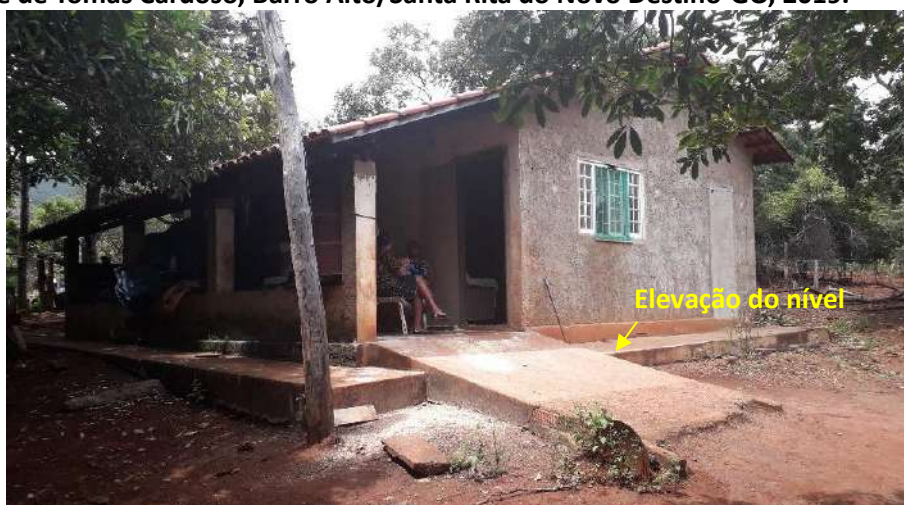
Foto 6.20 – Dispositivo de prevenção dos danos provocados pelas águas, em residência da Comunidade de Tomás Cardoso, Barro Alto/Santa Rita do Novo Destino-GO, 2019.
