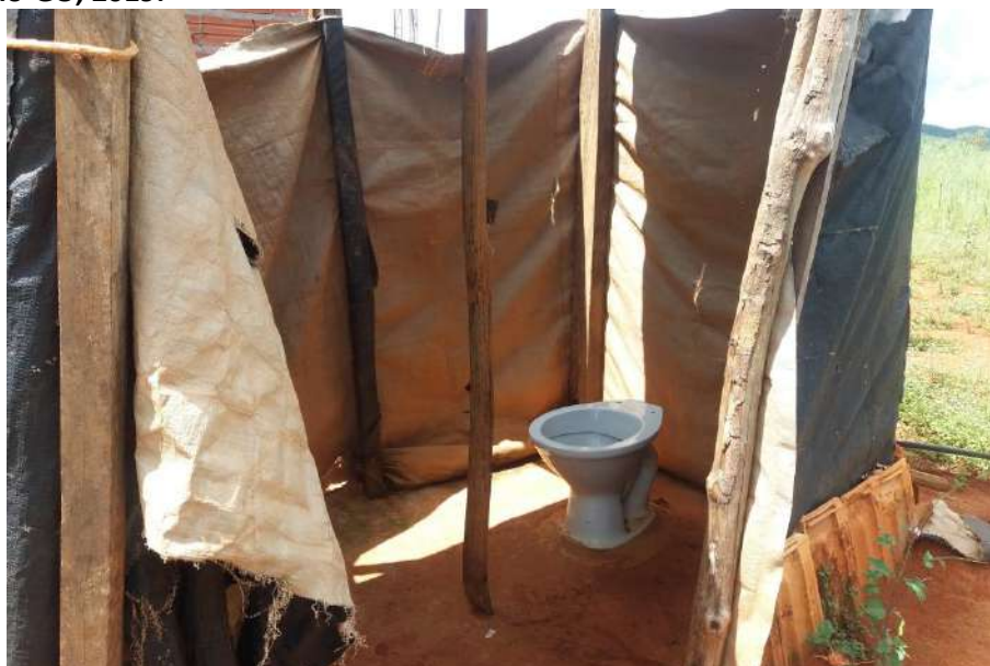
Foto 4.2 – Vaso sanitário identificado na Comunidade de Tomás Cardoso, Barro Alto/Santa Rita do Novo Destino-GO, 2019.
