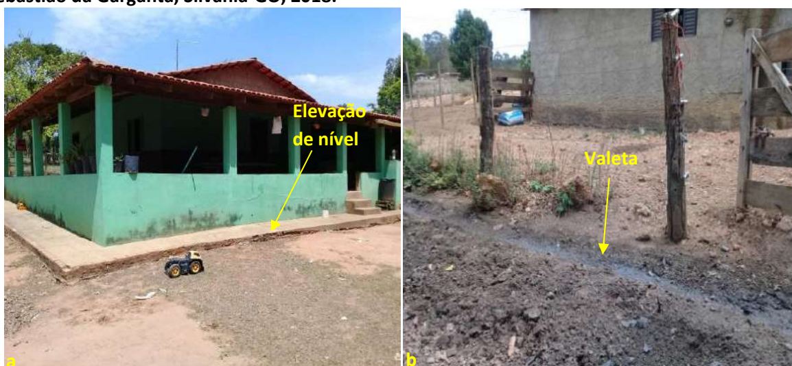
Foto 6.20 – Dispositivos de prevenção dos danos provocados pelas águas (a) e (b) Comunidade Sebastião da Garganta, Silvânia-GO, 2018.
