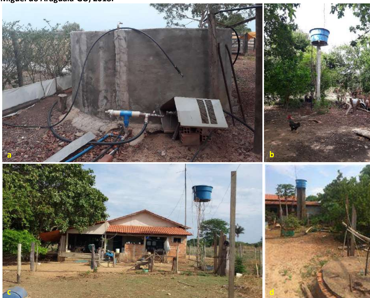
Foto 6.4 – Reservatório domiciliar apoiado ao solo (a), instalado sobre estrutura em concreto (b), estrutura metálica (c) e outro sobre estrutura em alvenaria (d), na Comunidade Rio Araguaia, São Miguel do Araguaia-GO, 2018.
