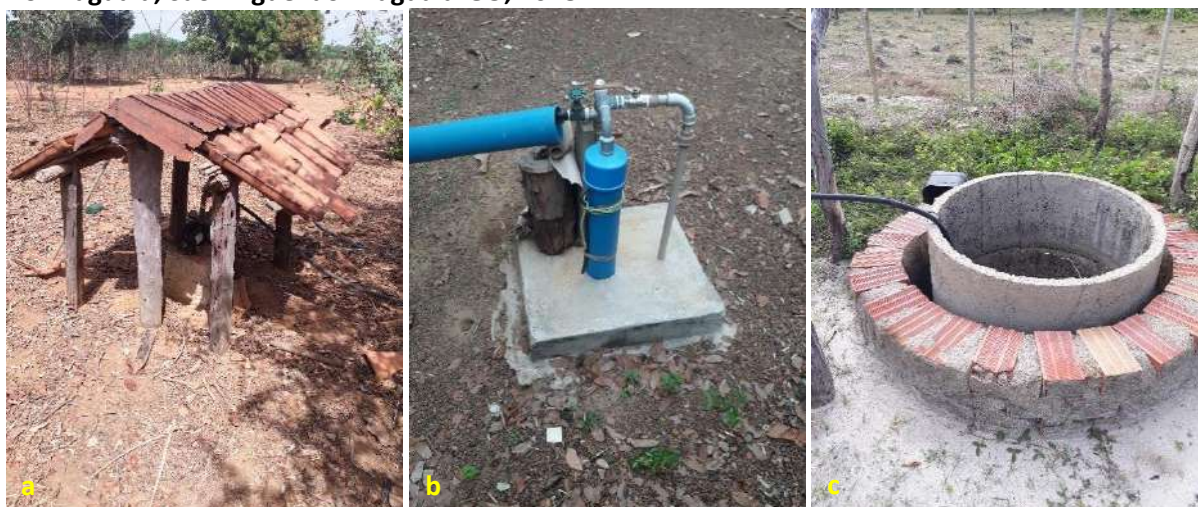
Foto 6.1 – Poço tubular raso (a), poço tubular profundo (b) e poço raso escavado (c), na Comunidade Rio Araguaia, São Miguel do Araguaia-GO, 2018.
