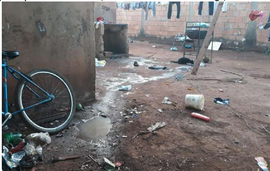
Foto 6.4 – Lançamento e acúmulo de água cinza proveniente do tanque de lavar roupas diretamente no solo do quintal próximo ao domicílio, na Comunidade Raízes do Congo, Itumbiara-GO, 2019.
