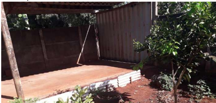
Foto 4.4 – Piso de residência constituído de concreto bruto, identificado na Comunidade Raízes do Congo, Itumbiara-GO, 2019.
