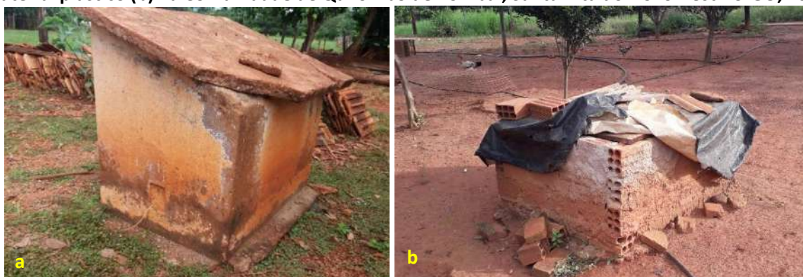
Foto 6.7 – Poços tubulares rasos no interior de abrigos em alvenaria, e laje em concreto (a) e com material plástico (b) na Comunidade de Quilombo de Pombal, Santa Rita do Novo Destino-GO, 2019.
