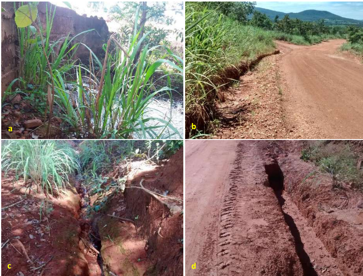
Foto 6.22 – Bueiro (a), valeta em boas condições (b) e valetas erodidas (c), (d) na via de acesso à Comunidade de Quilombo de Pombal, Santa Rita do Novo Destino-GO, 2019.
