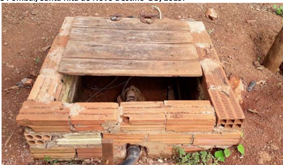
Foto 6.8 – Poço tubular profundo protegido por alvenaria e tampa de madeira na Comunidade de Quilombo de Pombal, Santa Rita do Novo Destino-GO, 2019.
