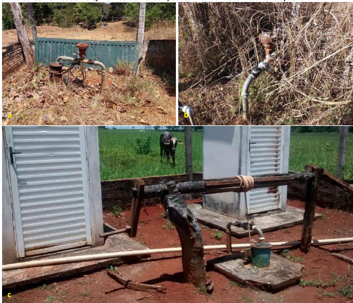
Foto 6.3 – Poços tubulares profundos, F1 (a), F2 (b) e F3 (c), respectivamente, fontes SSA1, SAA2 e SAA3 da Comunidade de Quilombo de Pombal, Santa Rita do Novo Destino-GO, 2019.
