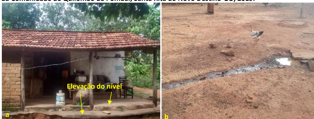
Foto 6.27 – Dispositivos de prevenção dos danos provocados pelas águas em residência (a) e lote (b) da Comunidade de Quilombo de Pombal, Santa Rita do Novo Destino-GO, 2019.
