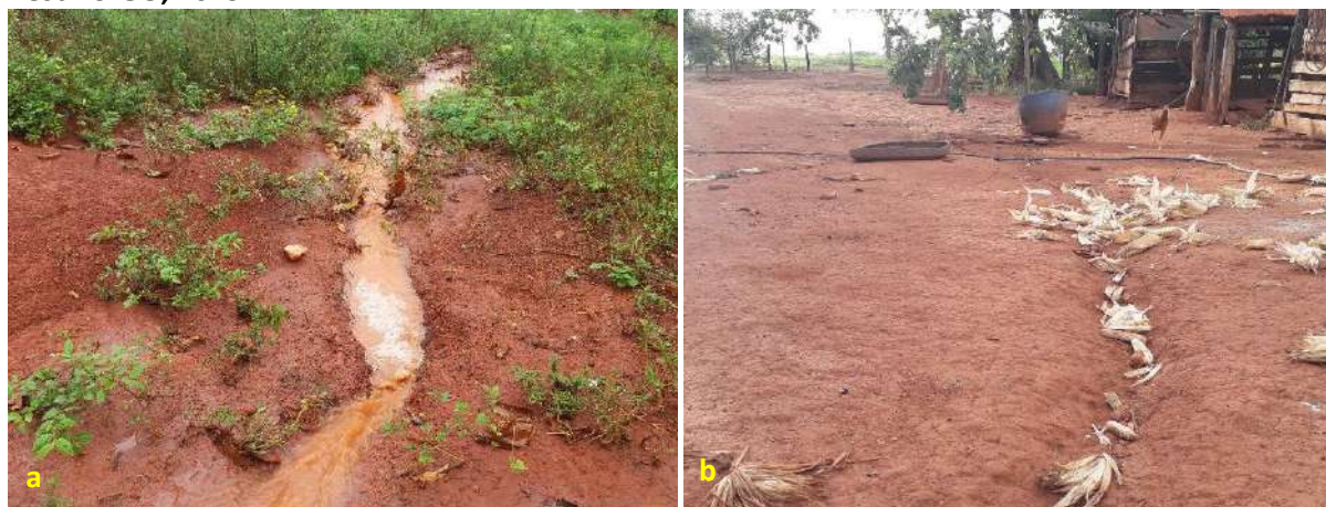
Foto 6.28 – Processos erosivos em lotes da Comunidade de Quilombo de Pombal, Santa Rita do Novo Destino-GO, 2019.
