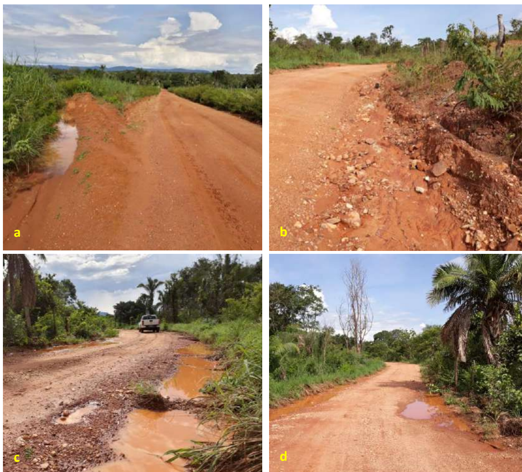
Foto 6.17 – Situação da drenagem pluvial na via de acesso: vala de infiltração (a), processo erosivo (b) e pontos de alagamento (c) e (d) na Comunidade de Pelotas, Monte Alegre de Goiás-GO, 2019.
