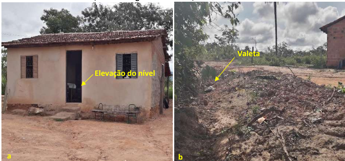
Foto 6.20 – Dispositivos de prevenção dos danos provocados pelas águas em residência (a) e lote (b) da Comunidade de Pelotas, Monte Alegre de Goiás-GO, 2019.
