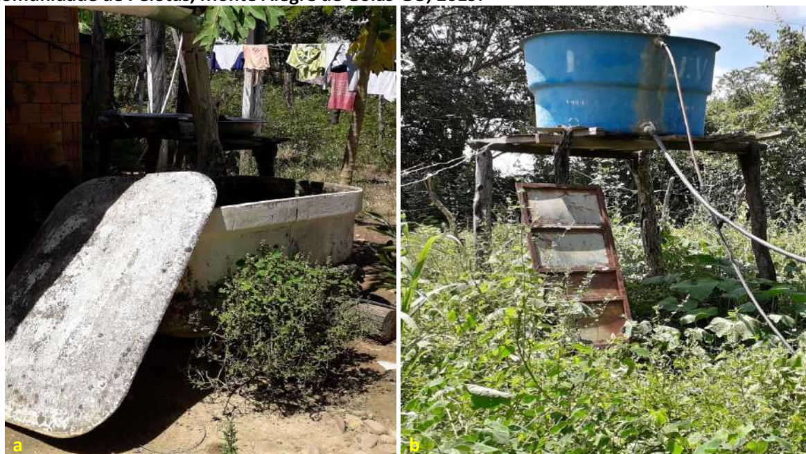
Foto 6.4 – Reservatório domiciliar de cimento amianto instalado diretamente sobre o solo (a), em fibra de vidro, com sinais de transbordamento instalado sobre estrutura de madeira(b), na Comunidade de Pelotas, Monte Alegre de Goiás-GO, 2019.
