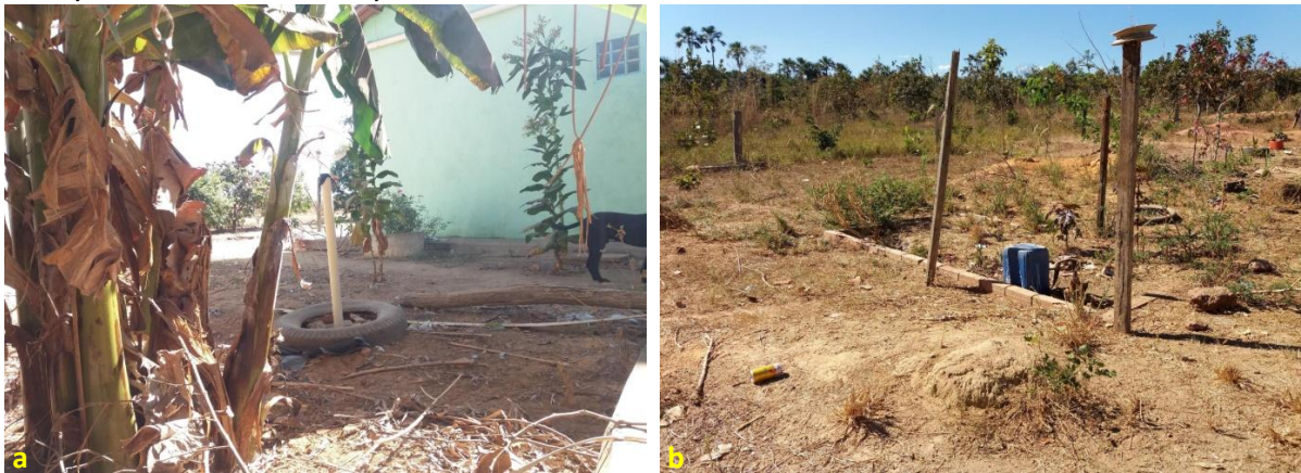
Foto 6.6 – Situações construtivas das fossas ecológicas sem mureta de proteção e com tubulação de respiro (a); e com mureta de proteção do sistema e tubulação de respiro (b), Comunidade Monte Moria, São Luiz do Norte-GO, 2018.
