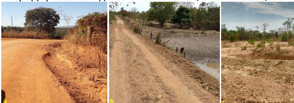
Foto 6.16 – Situação da drenagem pluvial na via de acesso: valeta de infiltração (a), bacia de infiltração (b) e processo erosivo (c) na Comunidade Monte Moria, São Luiz do Norte-GO, 2018.
