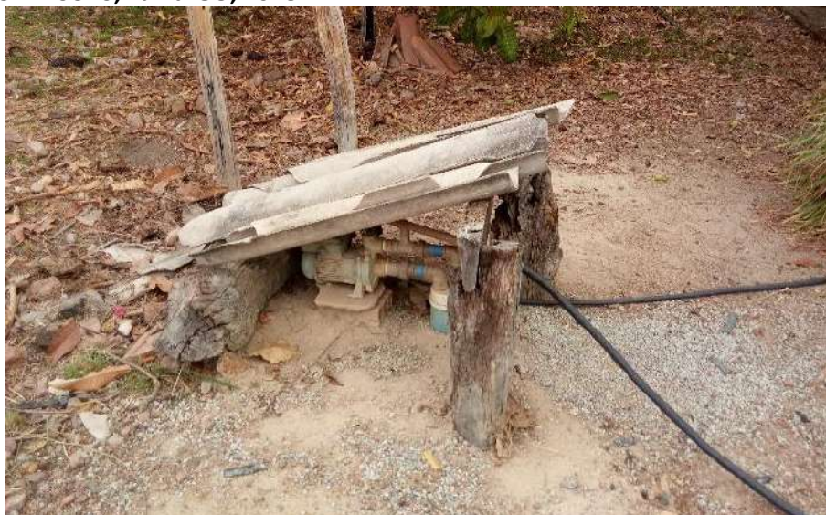
Foto 6.2 – Poço tubular raso tampado de forma improvisada com telha de fibrocimento, na Comunidade Limoeiro, Faina-GO, 2018.
