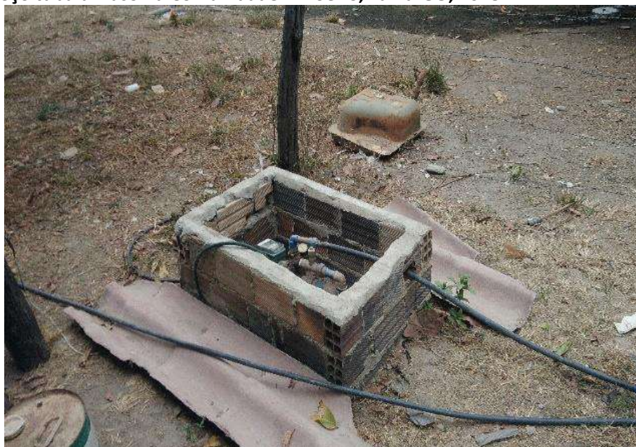
Foto 6.1 – Poço tubular raso na Comunidade Limoeiro, Faina-GO, 2018.
