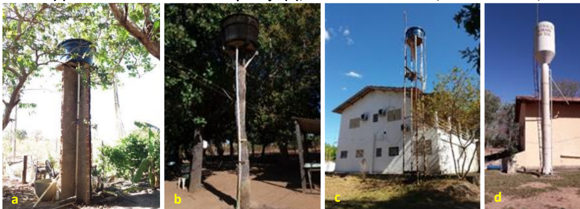
Foto 6.5 – Reservatório instalado sobre estrutura de alvenaria (a), madeira (b) ou de material metálico (c) e reservatório elevado do tipo taça (d), na Comunidade Landi, Nova Crixás-GO, 2019.
