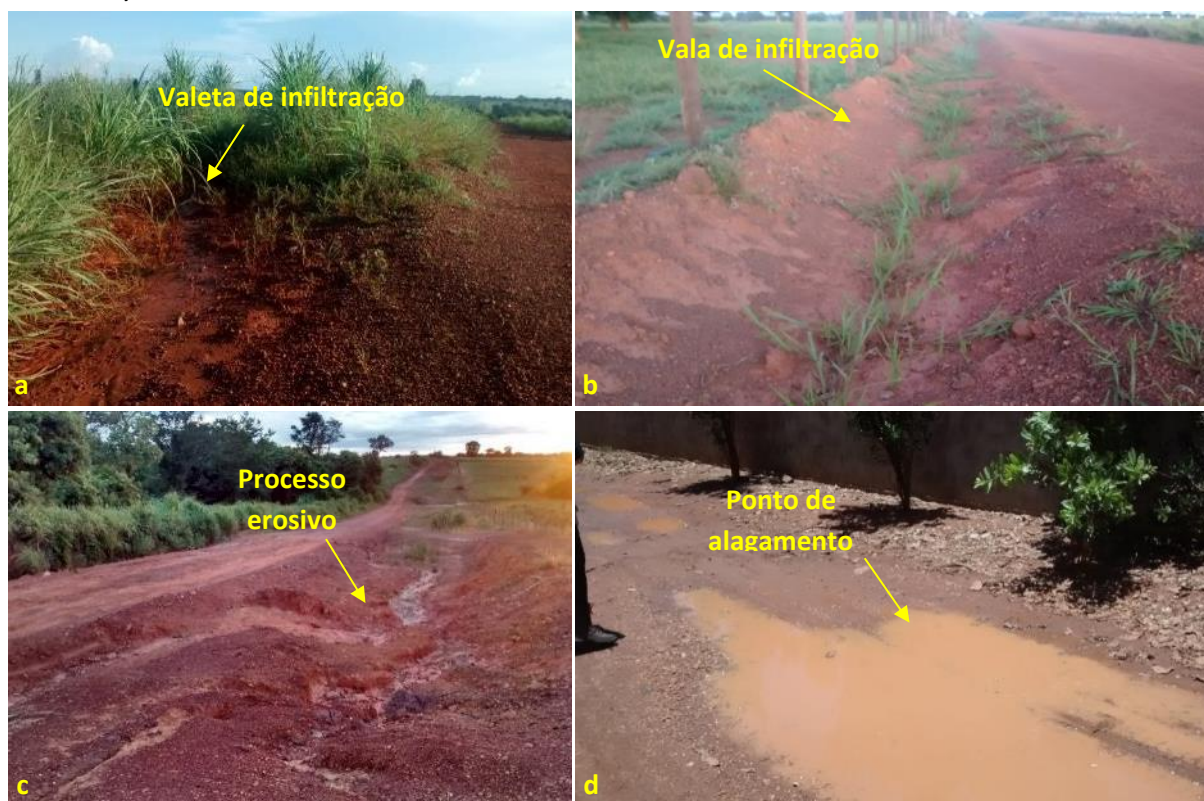
Foto 6.17 – Situação da drenagem pluvial na via de acesso: valeta de infiltração (a), vala de infiltração (b), processo erosivo (c) e ponto de alagamento (d) na via de acesso à Comunidade Landi, Nova Crixás-GO, 2019.
