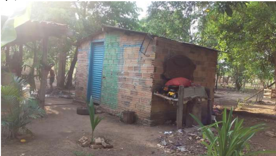
Foto 4.12 – Extensão habitacional com cobertura de fibrocimento, identificada na Comunidade Lagoa Genipapo, Nova Crixás-GO, 2018.
