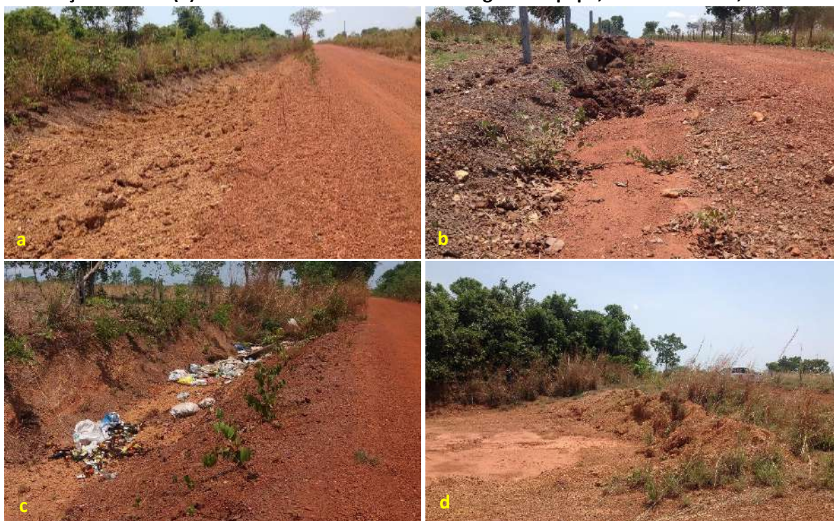
Foto 6.13 – Valeta (a), valeta obstruída (b), ponto de descarte de resíduos sólidos na valeta (c) e ponto de extração de terra (d) na via de acesso à Comunidade Lagoa Genipapo, Nova Crixás-GO, 2018.
