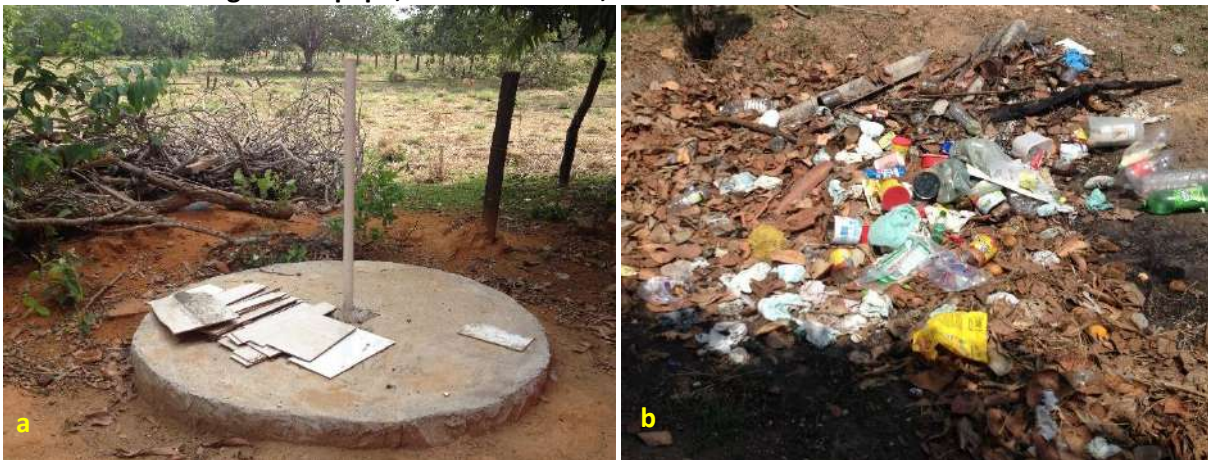
Foto 6.5 – Situações construtivas das fossas negras/rudimentares, com tampa de concreto e tubulação de respiro sem proteção (a), tampa sob o solo, restos de folhagens e resíduos sólidos (b), na Comunidade Lagoa Genipapo, Nova Crixás-GO, 2018.
