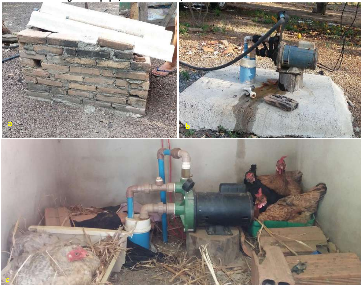
Foto 6.3 – Poço tubular raso: protegido em abrigo de alvenaria e coberto com telhas de fibrocimento (a); com base em concreto mas sem proteção no entorno (b), em abrigo compartilhado com aves (c), na Comunidade Lagoa Genipapo, Nova Crixás-GO, 2018.
