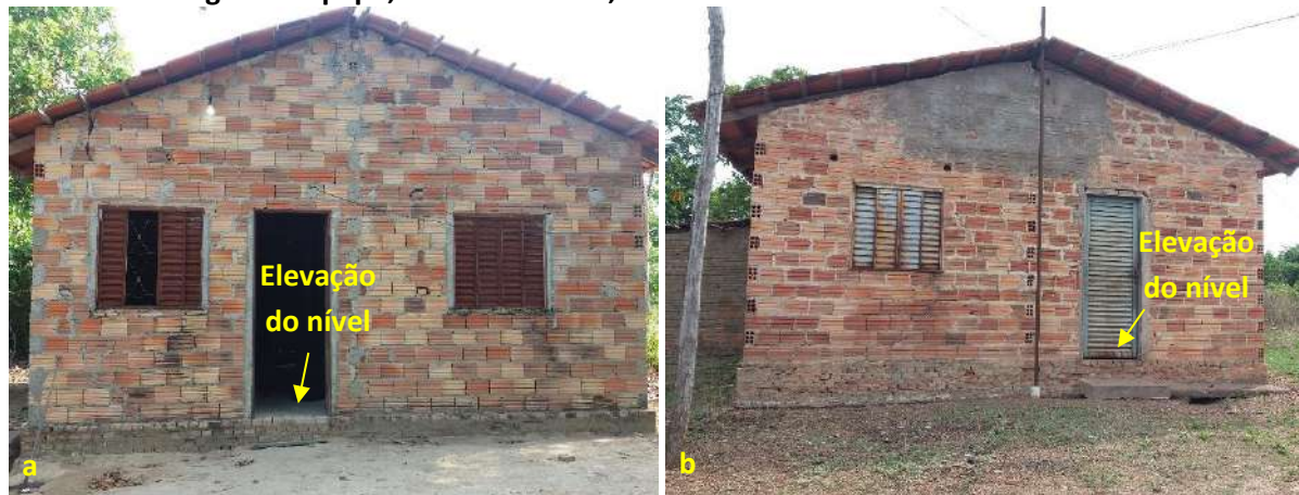
Foto 6.16 – Dispositivos de prevenção dos danos provocados pelas águas em residências da Comunidade Lagoa Genipapo, Nova Crixás-GO, 2018.
