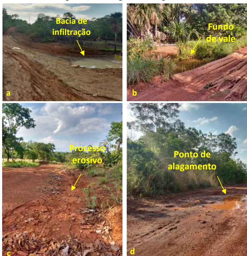
Foto 6.20 – Bacia de infiltração (a), fundo de vale (b), processo erosivo (c) e ponto de alagamento (d) na via de acesso à Comunidade Lageado, São Miguel do Araguaia-GO, 2018.
