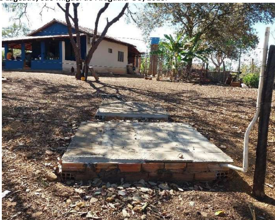
Foto 6.7 – Fossa séptica com tampa de concreto armado e tubulação de respiro sem vedação, na Comunidade Lageado, São Miguel do Araguaia-GO, 2018.
