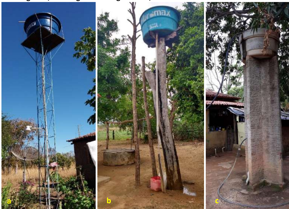
Foto 6.5 – Reservatório domiciliar com extravasador, instalado sobre estrutura de ferro (a), de madeira (b) e reservatório em fibrocimento, com vazamento, instalado sobre estrutura de alvenaria (c), na Comunidade Lageado, São Miguel do Araguaia-GO, 2018.
