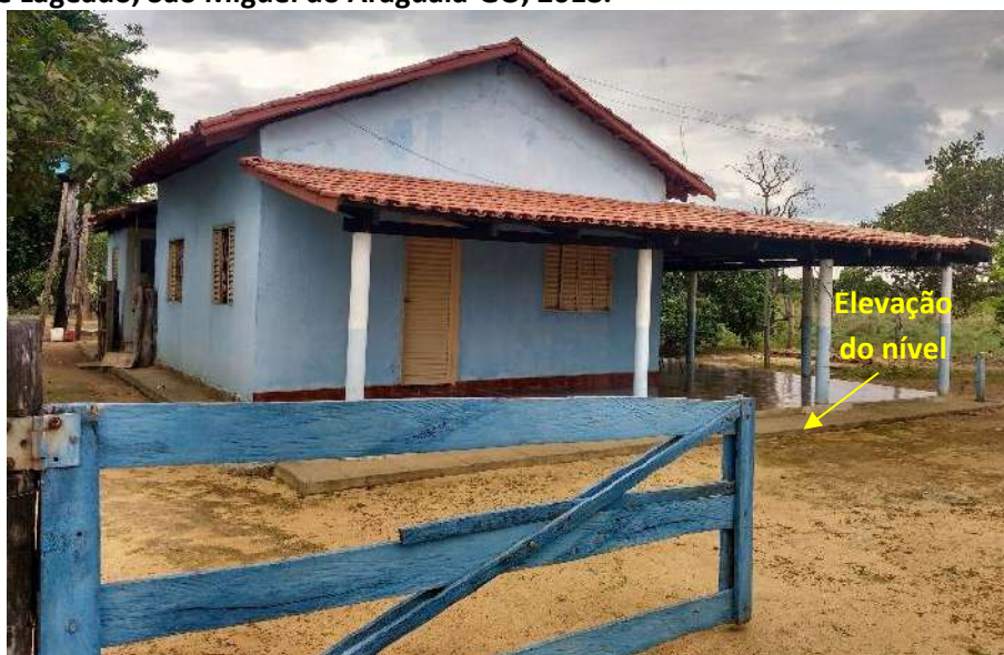
Foto 6.22 – Dispositivo de prevenção dos danos provocados pelas águas em residência da Comunidade Lageado, São Miguel do Araguaia-GO, 2018.
