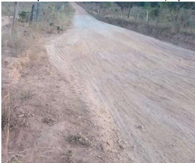
Foto 6.17 – Via de acesso não pavimentada na Comunidade José Martí, Niquelândia-GO, 2018.
