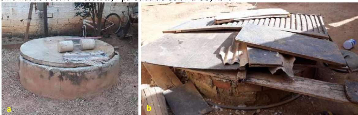
Foto 6.1 – Poço raso escavado com mureta de proteção, tampado com tampa de concreto e sem calçamento ao redor (a), e outro tampado com uma porta metálica, madeira e telha (b), na Comunidade de Jardim Cascata, Aparecida de Goiânia-GO, 2019.
