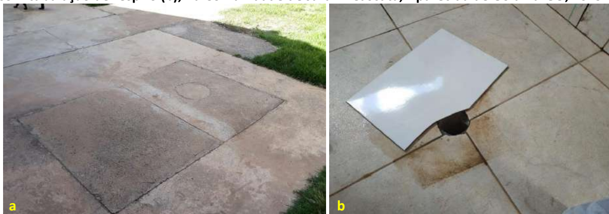
Foto 6.5 – Situações construtivas das fossas séptica com sumidouro sem tubulação (a) e fossa séptica com tubulação de respiro (b), na Comunidade de Jardim Cascata, Aparecida de Goiânia-GO, 2019.
