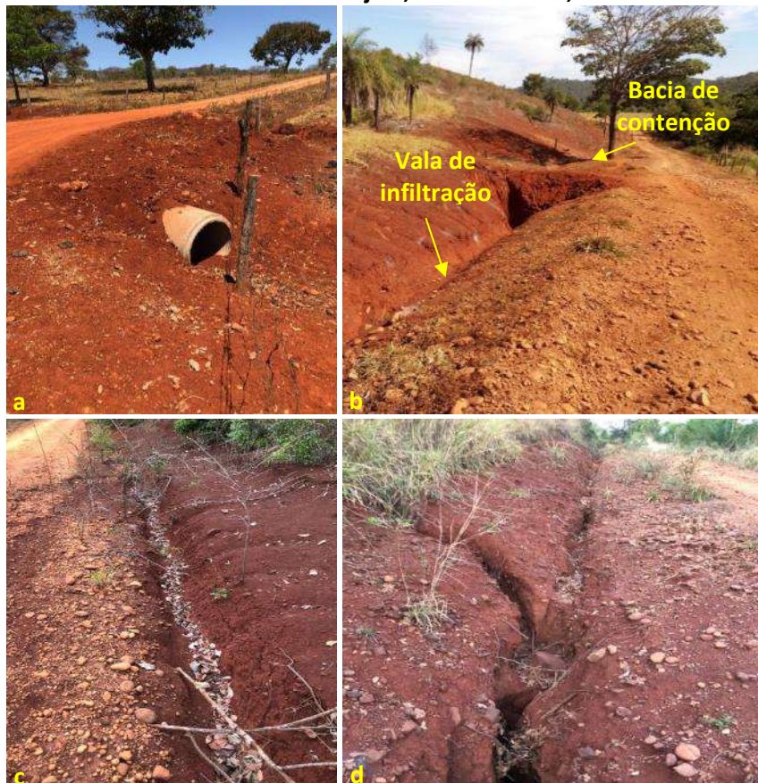
Foto 6.17 – Bueiro (a), vala de infiltração e bacia de contenção (b), valeta (c) e processo erosivo (d) nas margens da via de acesso à Comunidade Itajá II, Goianésia-GO, 2018.
