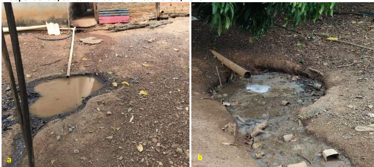
Foto 6.10 – Lançamento e acúmulo de água cinza proveniente da pia da cozinha e/ou do tanque de lavar roupas diretamente no solo do quintal próximo aos domicílios (a) e (b), na Comunidade Independência, Santa Rita do Novo Destino-GO, 2018.
