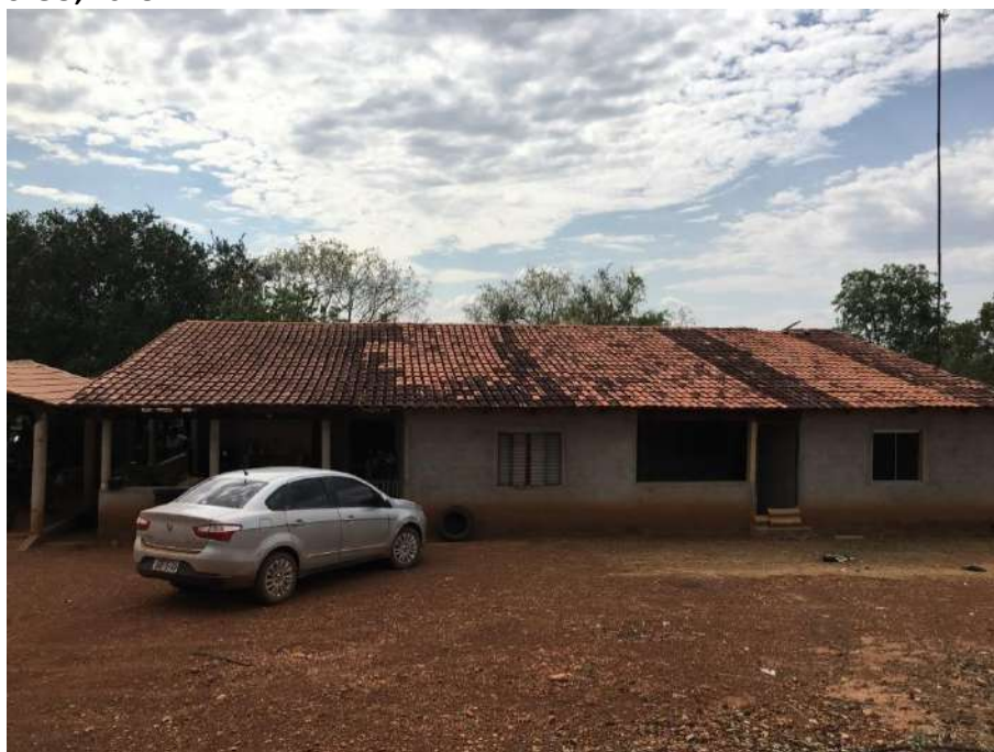
Foto 4.10 – Cobertura de telha de barro, identificada na Comunidade Independência, Santa Rita do Novo Destino-GO, 2018.
