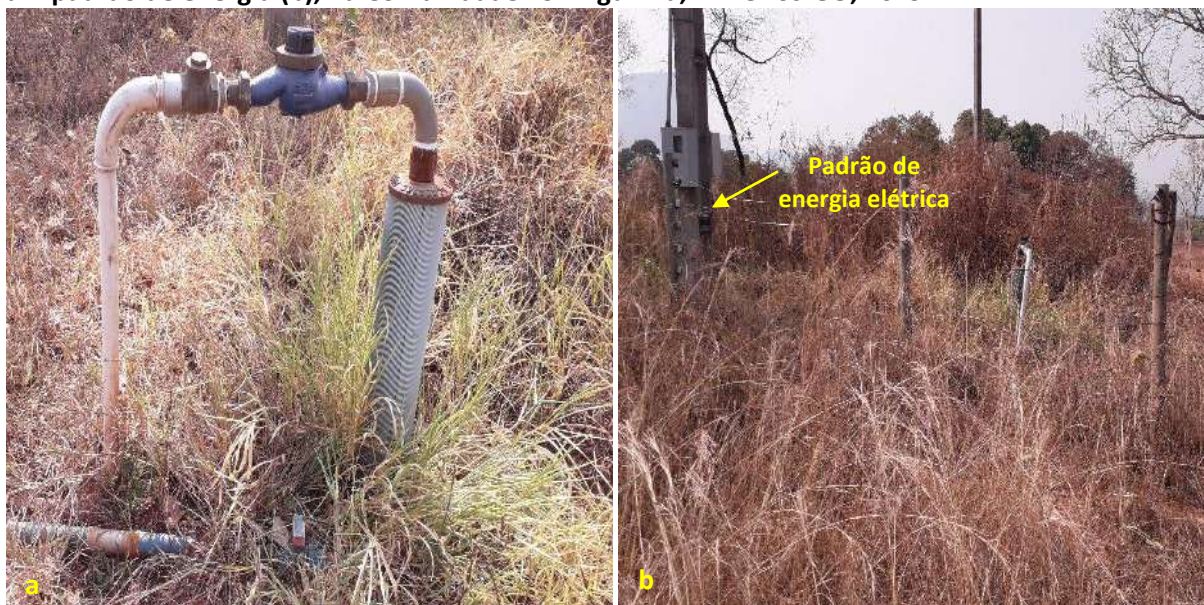
Foto 6.2 – Área de captação do SAA com poço tubular profundo F1 (a), isolada por cerca, contendo um padrão de energia (b), na Comunidade Formiguinha, Mineiros-GO, 2019.
