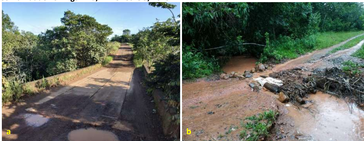
Foto 6.15 – Ponte sobre córrego Barreirinho (a) e passagem precária por corpo d'água (b), na Comunidade Formiguinha, Mineiros-GO, 2019.
