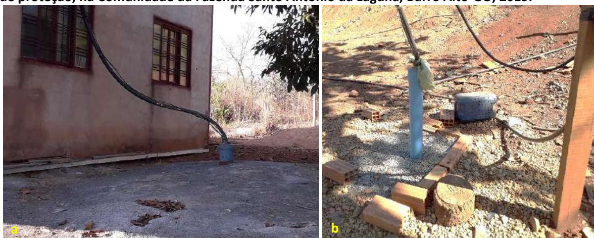
Foto 6.1 – Poço tubular profundo próximo à residência (a) e poço tubular raso (b) sem mecanismos de proteção, na Comunidade da Fazenda Santo Antônio da Laguna, Barro Alto-GO, 2019.
