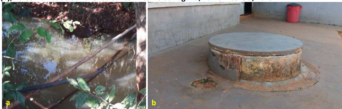
Foto 6.2 – Captação em nascente, mina ou bica (a) e poço raso com mureta, próximo à residência (b), na Comunidade da Fazenda Santo Antônio da Laguna, Barro Alto-GO, 2019.
