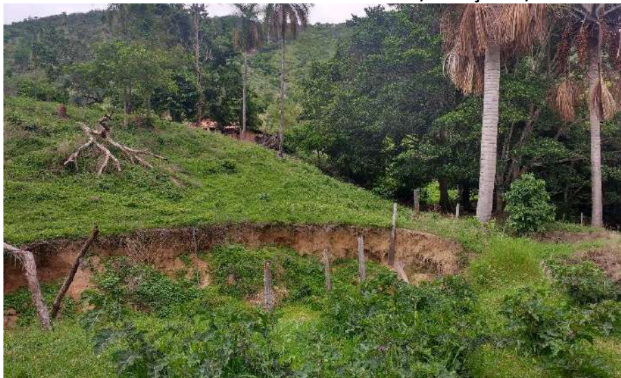
Foto 6.26 – Processo erosivo em lote da Comunidade Céu Azul, Minaçu-GO, 2018.
