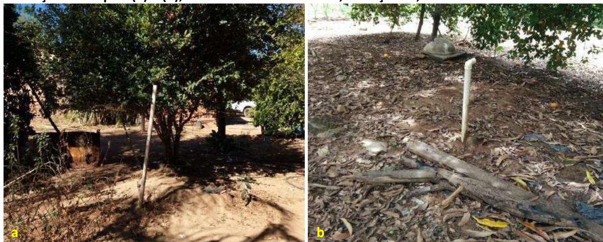
Foto 6.8 – Situações construtivas das fossas negras/rudimentares, abaixo do nível do solo e com tubulação de respiro (a) e (b), na Comunidade Céu Azul, Minaçu-GO, 2018.
