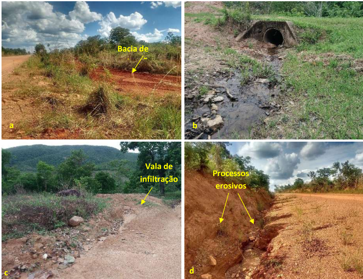
Foto 6.21 – Situação da drenagem pluvial na via de acesso: bacia de contenção (a), bueiro (b), vala de infiltração (c) e processos erosivos (d), na Comunidade Céu Azul, Minaçu-GO, 2018.
