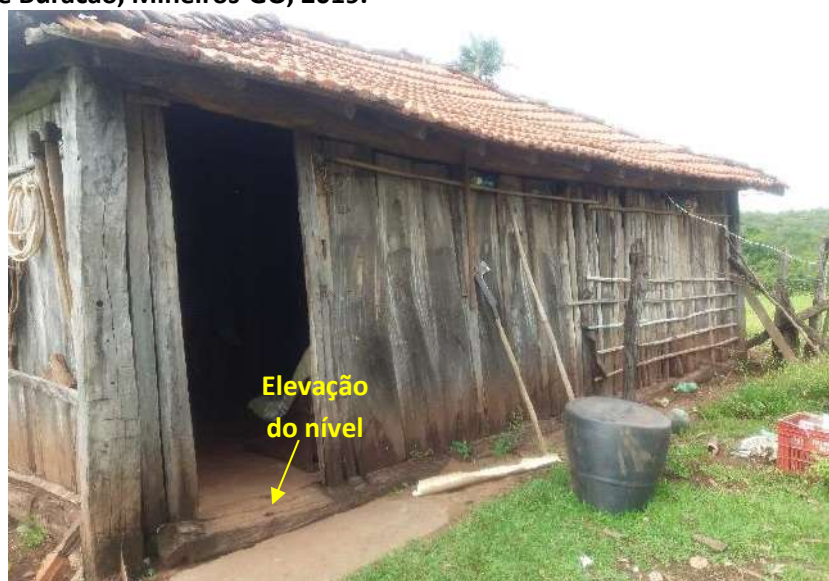
Foto 6.19 – Dispositivo de prevenção dos danos provocados pelas águas em residência da Comunidade de Buracão, Mineiros-GO, 2019.
