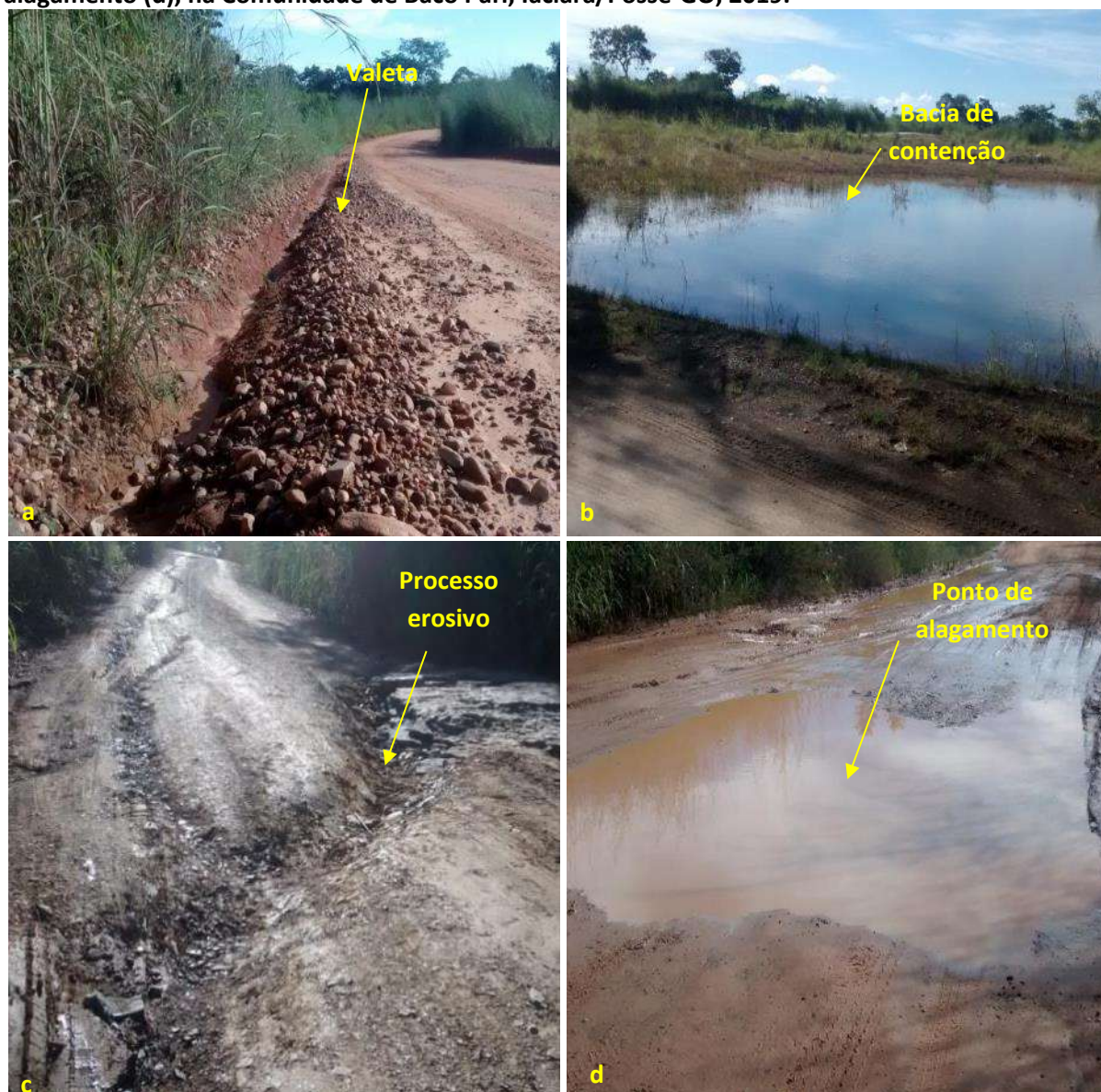
Foto 6.21 – Via de acesso com valeta (a), bacia de contenção (b), processo erosivo (c) e ponto de alagamento (d), na Comunidade de Baco Pari, Iaciara/Posse-GO, 2019.
