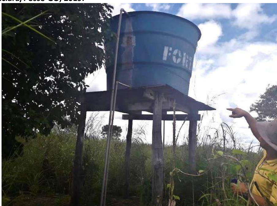
Foto 6.4 – Reservatório coletivo R2, instalado sobre uma estrutura de madeira na Comunidade de Baco Pari, Iaciara/Posse-GO, 2019.
