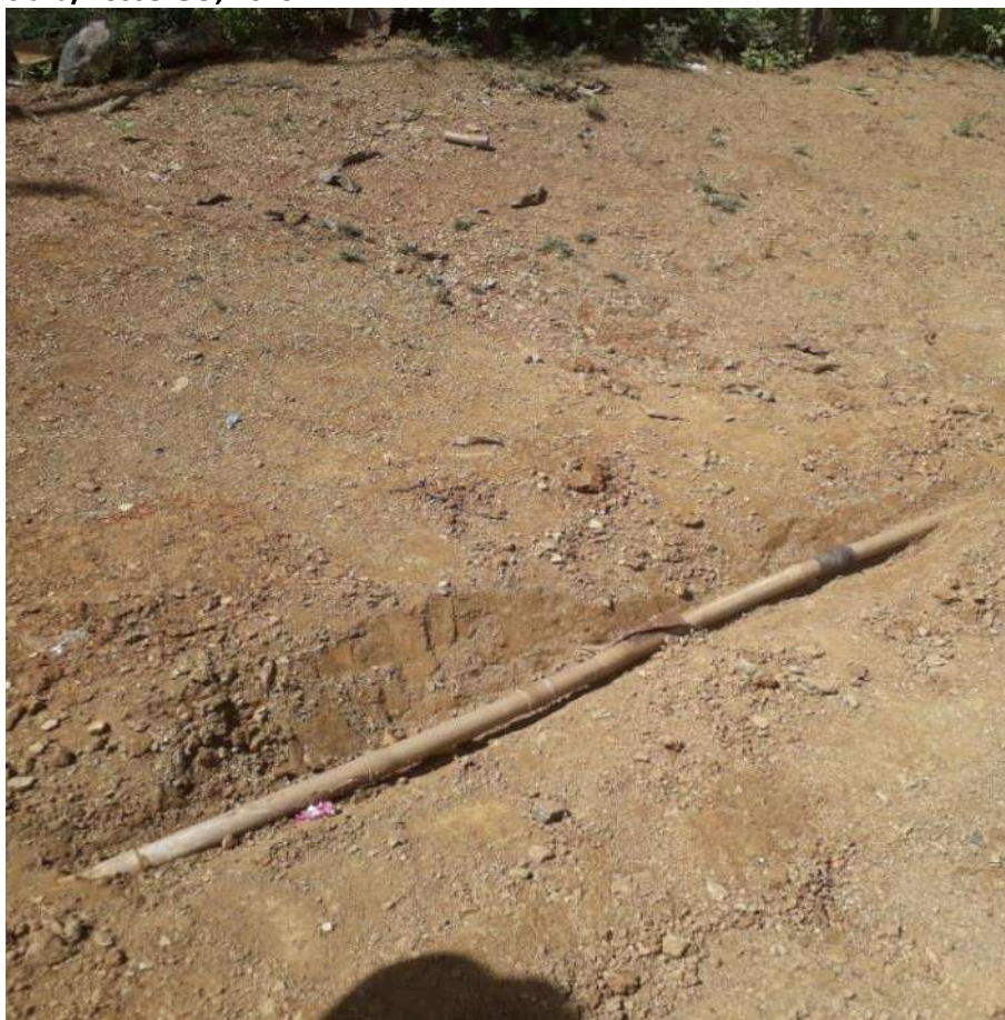
Foto 6.5 – Tubulação da rede de distribuição do SAA estancada pelos moradores da Comunidade de Baco Pari, Iaciara/Posse-GO, 2019.
