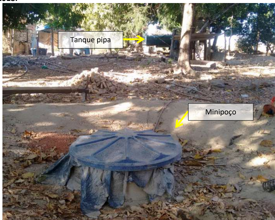
Foto 6.4 – Minipoço e tanque pipa utilizados em um domicílio da Comunidade Abobreira, Nova Roma-GO, 2018.
