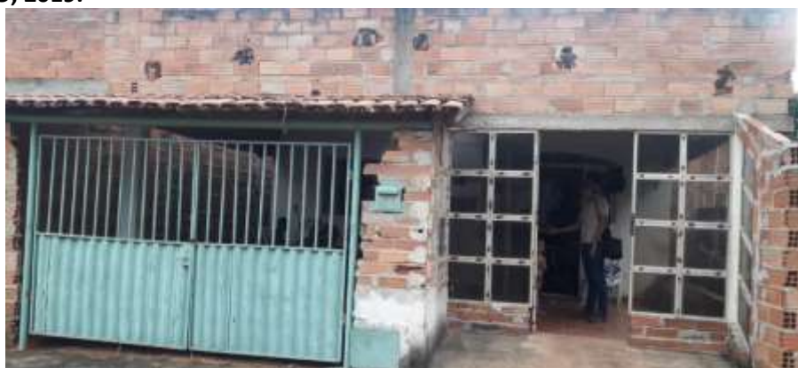
Foto 4.8 – Habitação construída de alvenaria sem reboco, identificada na Comunidade de Vó Rita, Trindade-GO, 2019.
