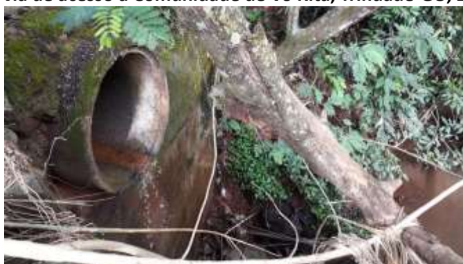
Foto 6.14 – Bueiro na via de acesso à Comunidade de Vó Rita, Trindade-GO, 2019.
