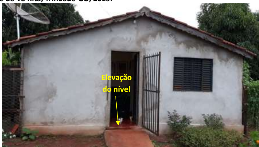
Foto 6.15 – Dispositivo de prevenção dos danos provocados pelas águas em residência da Comunidade de Vó Rita, Trindade-GO, 2019.
