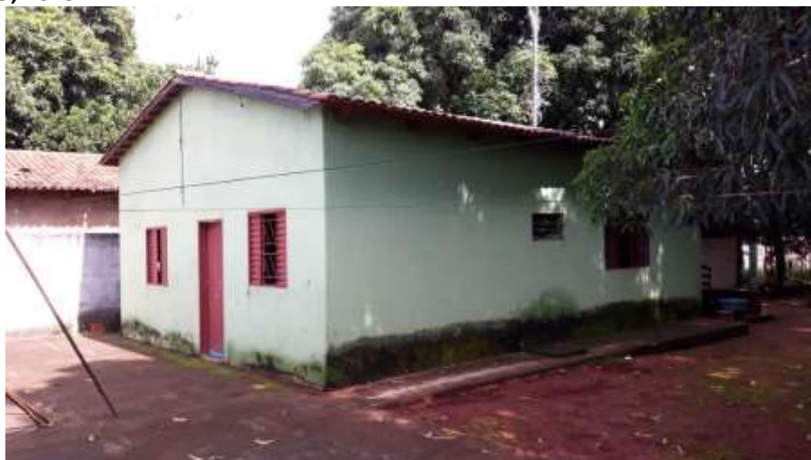
Foto 4.14 – Cobertura de telha de barro, identificada nas habitações da Comunidade de Vó Rita, Trindade-GO, 2019.
