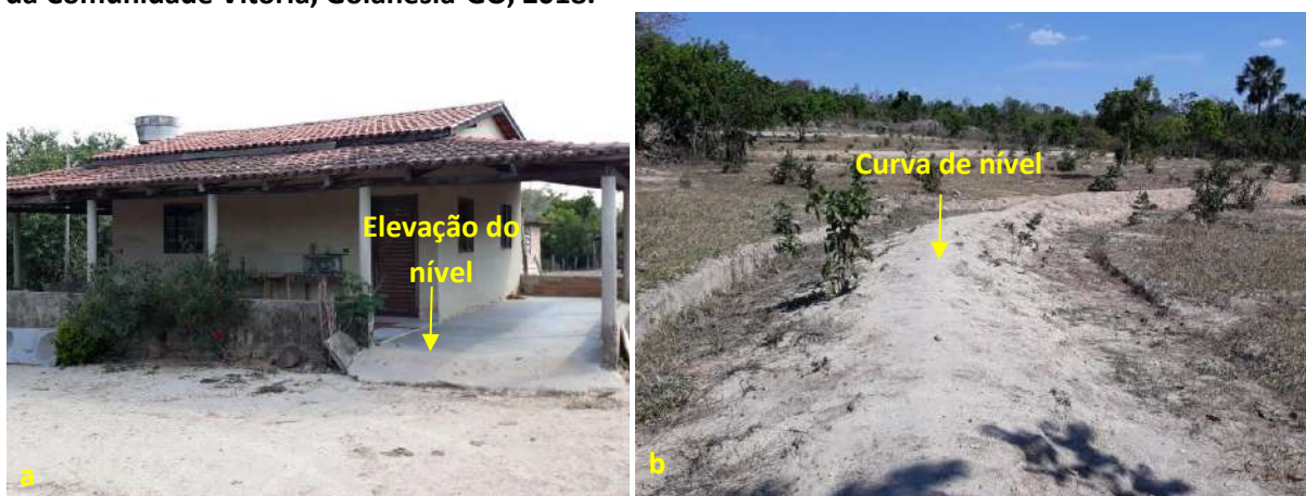
Foto 6.22 – Dispositivos de prevenção dos danos provocados pelas águas em residência (a) e lote (b) da Comunidade Vitória, Goianésia-GO, 2018.
