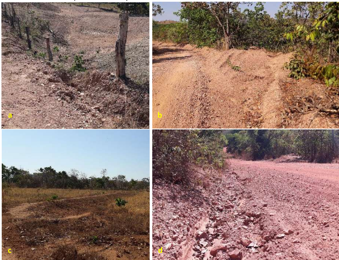
Foto 6.18 – Vala de infiltração (a), valeta (b), curva de nível (c) e processo erosivo (d) na via de acesso à Comunidade Vitória, Goianésia-GO, 2018.
