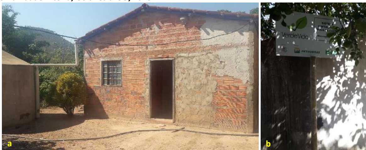
Foto 6.5 – Sistema de captação de água de chuva (a) e cisterna do projeto Verde Vida (b), na Comunidade Vitória, Goianésia-GO, 2018.
