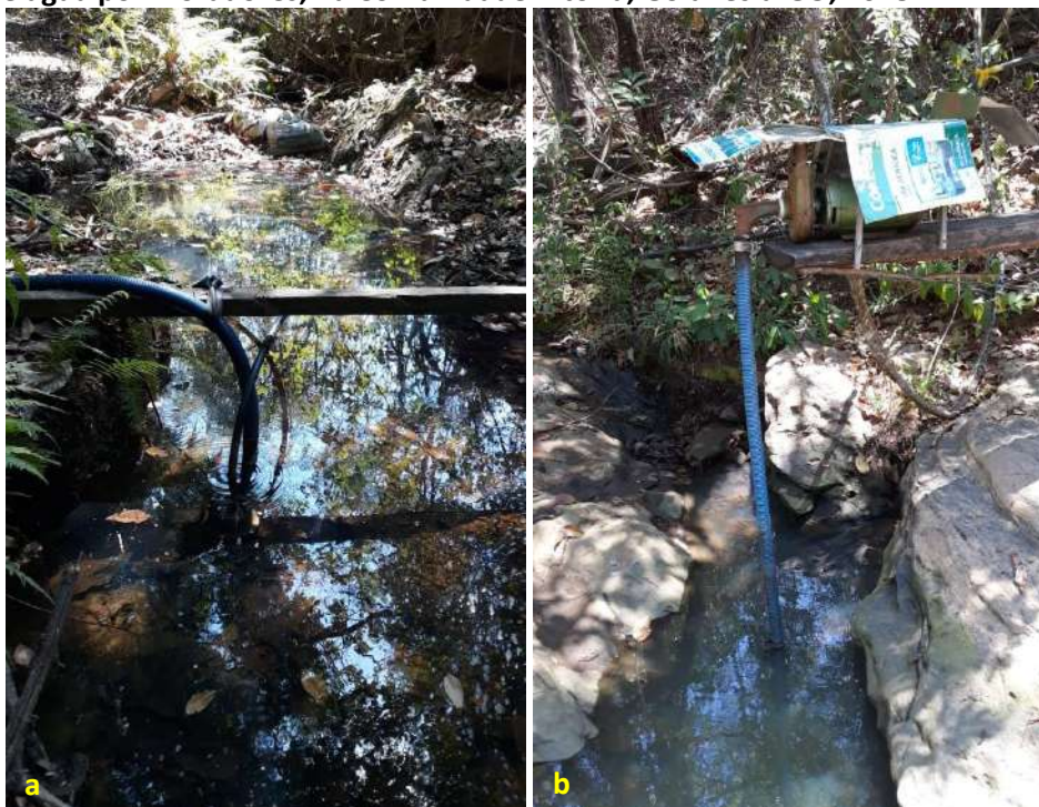
Foto 6.2 – Conjunto motobomba subsersível (a) e outro de eixo horizontal (b), utilizados para captação de água por moradores, na Comunidade Vitória, Goianésia-GO, 2018.
