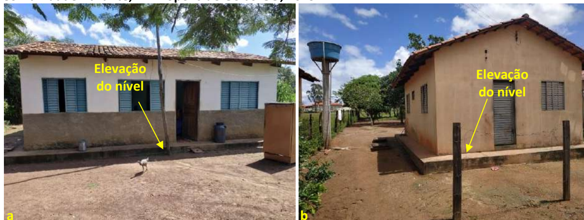
Foto 6.18 – Dispositivos de prevenção dos danos provocados pelas águas nas residências da Comunidade Vazante, Divinópolis de Goiás-GO, 2019.
