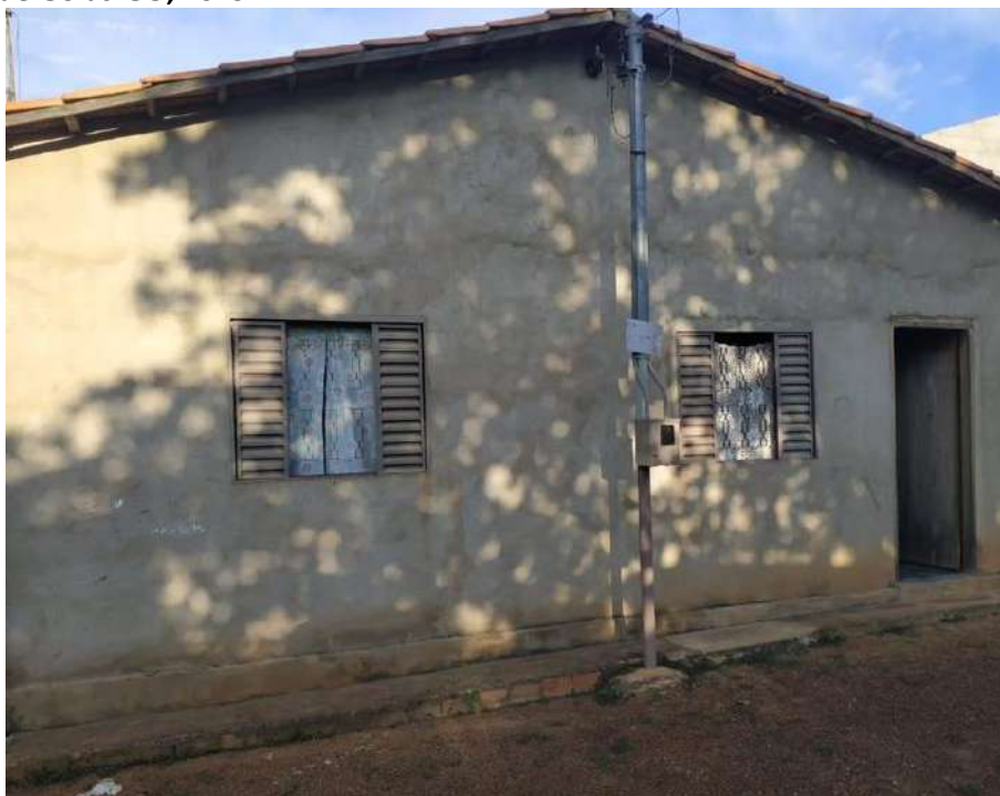
Foto 4.22 – Habitação construída de alvenaria com reboco identificada na Comunidade Vazante, Divinópolis de Goiás-GO, 2019.
