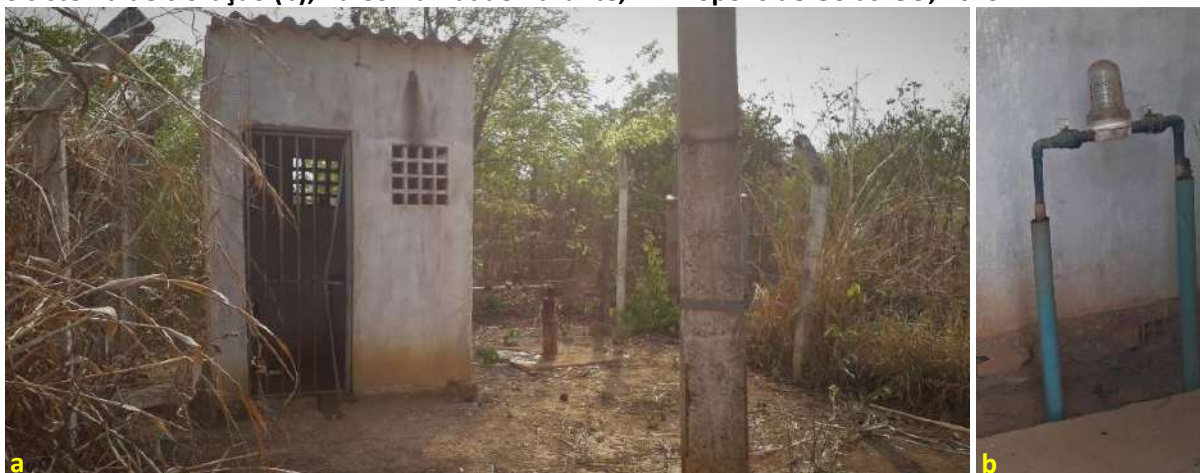
Foto 6.3 – Poço tubular profundo F2, com estrutura em alvenaria à esquerda (a), onde está localizado o sistema de cloração (b), na Comunidade Vazante, Divinópolis de Goiás-GO, 2019.
