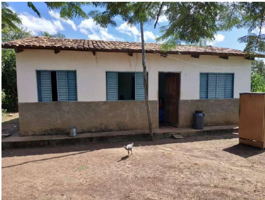
Foto 4.27 – Cobertura de telha de barro, identificada na Comunidade Vazante, Divinópolis de Goiás-GO, 2019.
