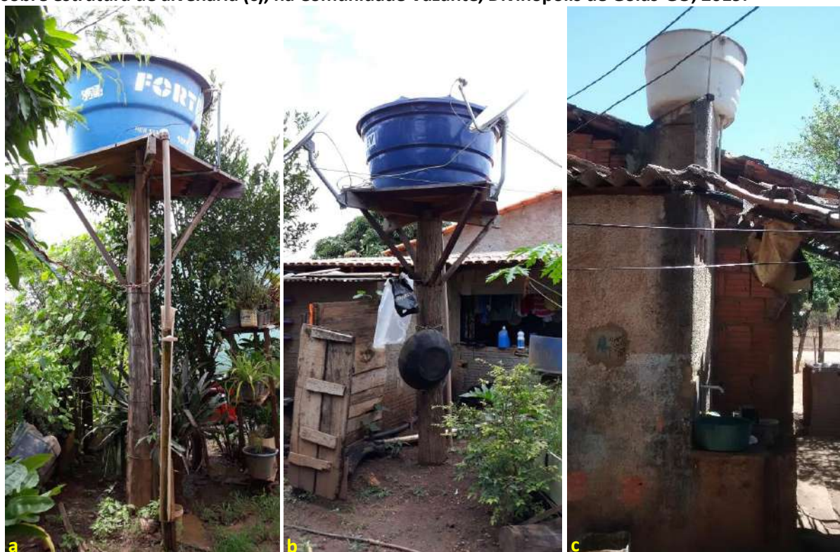
Foto 6.6 – Reservatórios domiciliares em diferentes situações e materiais, sendo um em fibra de vidro (a) e outro em polietileno (b), instalados sobre estrutura de madeira, e de material não identificado sobre estrutura de alvenaria (c), na Comunidade Vazante, Divinópolis de Goiás-GO, 2019.
