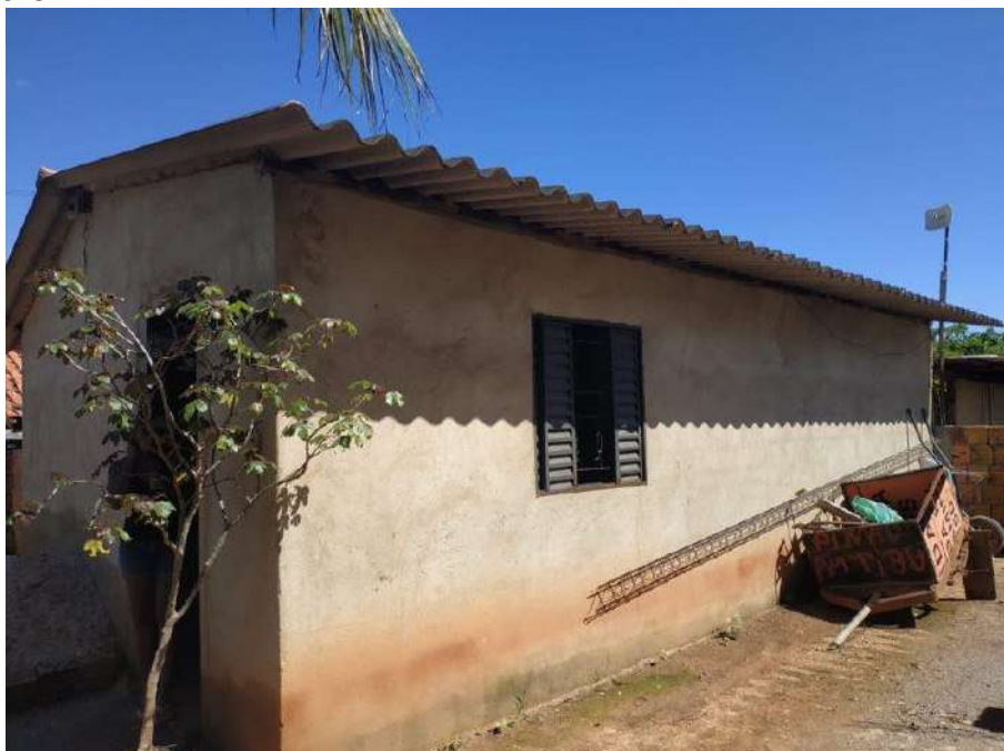
Foto 4.28 – Cobertura de telha de fibrocimento, identificada na Comunidade Vazante, Divinópolis de Goiás-GO, 2019.
