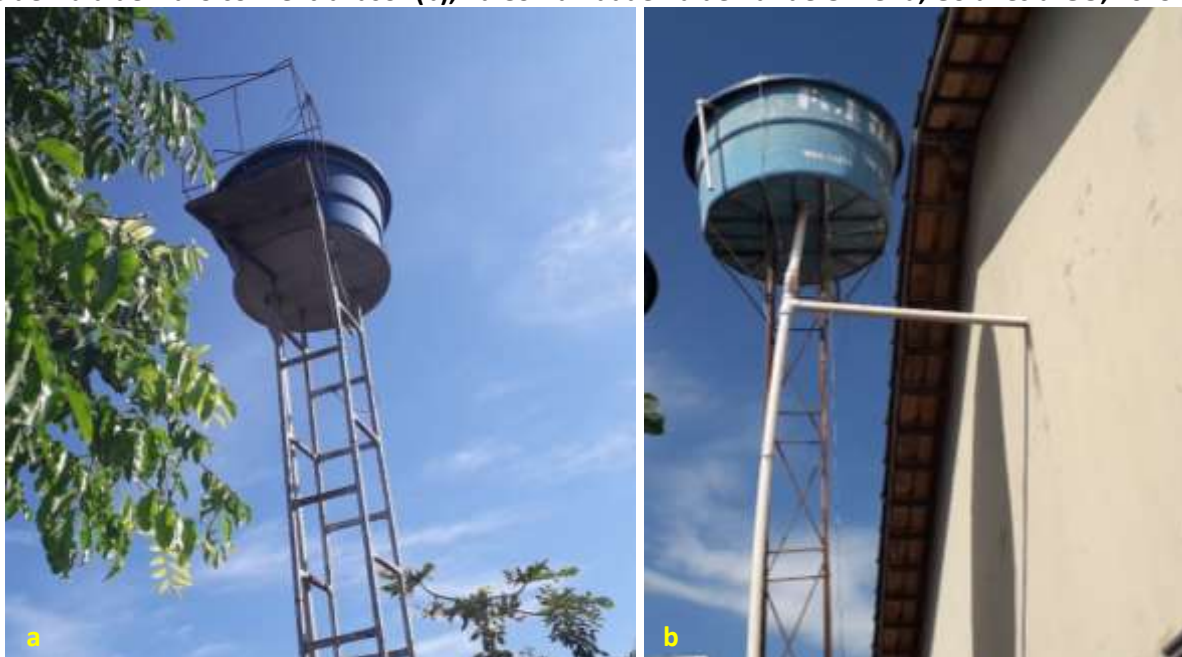
Foto 6.2 – Reservatórios domiciliares instalados sobre estruturas metálicas, sendo de polietileno (a) e de fibra de vidro com extravasor (b), na Comunidade Valdemar de Oliveira, Goianésia-GO, 2019.
