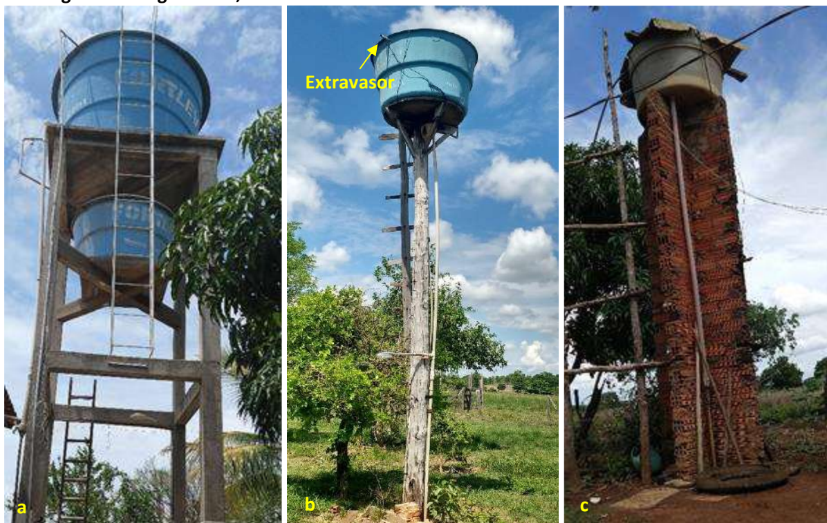
Foto 6.5 – Exemplo de dois reservatórios de fibra de vidro (a), de fibra de vidro com presença de extravasor (b) e de fibrocimento com tampa improvisada de telha (c), na Comunidade Umuarama, São Miguel do Araguaia-GO, 2018.
