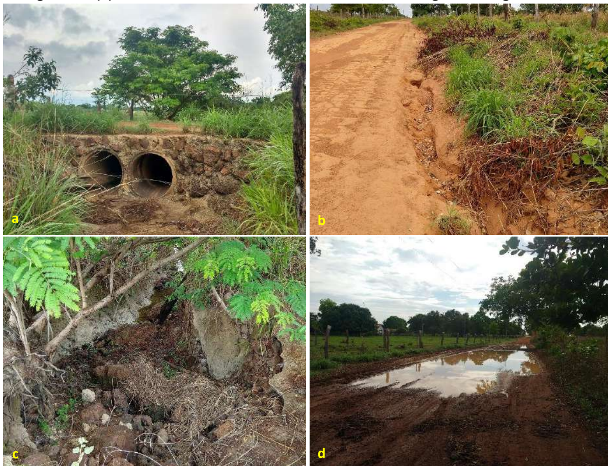
Foto 6.19 – Bueiros (a), vala de infiltração erodida (b), processo erosivo na margem da via (c) e ponto de alagamento (d) na via de acesso à Comunidade Umuarama, São Miguel do Araguaia-GO, 2018.
