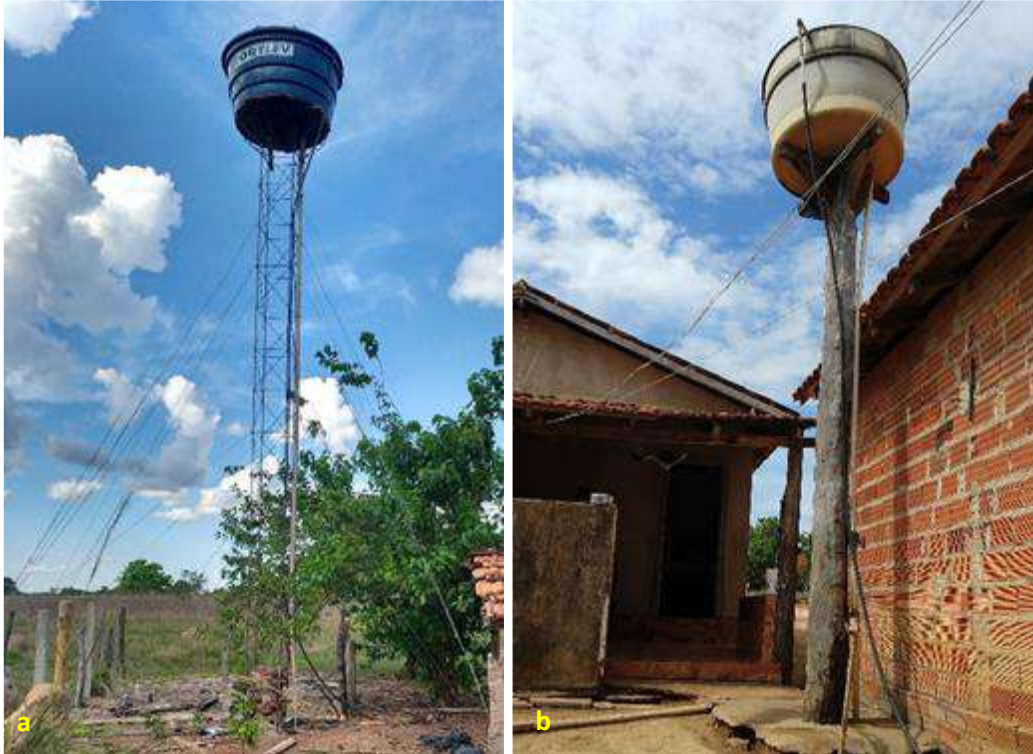
Foto 6.6 – Reservatório de polietileno sobre estrutura metálica (a) e reservatório de fibrocimento sobre estruturas de madeira (b), na Comunidade Umarama, São Miguel do Araguaia-GO, 2018.
