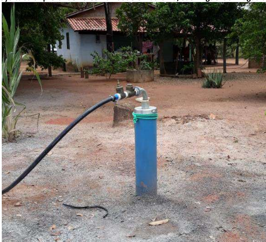
Foto 6.4 – Poço tubular profundo na Comunidade Umuarama, São Miguel do Araguaia-GO, 2018.
