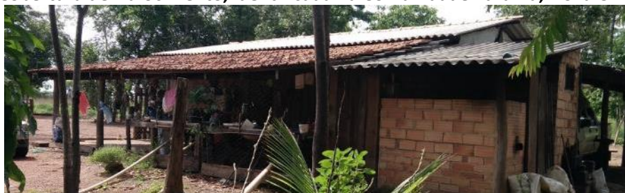
Foto 4.12 – Cobertura de fibrocimento, identificada na Comunidade Tatumã, Nova Crixás-GO, 2018.
