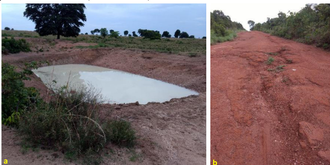
Foto 6.19 – Situação da drenagem pluvial na via de acesso: bacia de contenção (a) e processo erosivo (b) na Comunidade Tarumã, Nova Crixás-GO, 2018.
