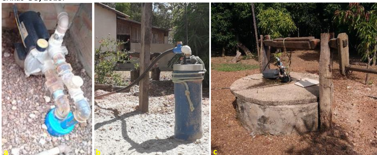
Foto 6.1 – Diferentes tipos de poços utilizados para obtenção de água de ingestão, tal como o poço tubular raso (a), poço tubular profundo (b) e poço raso escavado (c), pela Comunidade Tarumã, Nova Crixás-GO, 2018.
