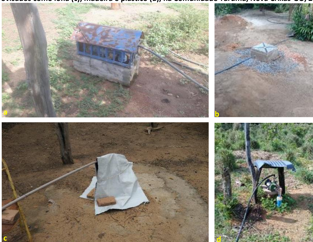
Foto 6.2 – Poços tubulares rasos protegidos por abrigos metálicos (a) e de alvenaria (b) ou materiais improvisados como lona (c), madeira e plástico (d), na Comunidade Tarumã, Nova Crixás-GO, 2018.
