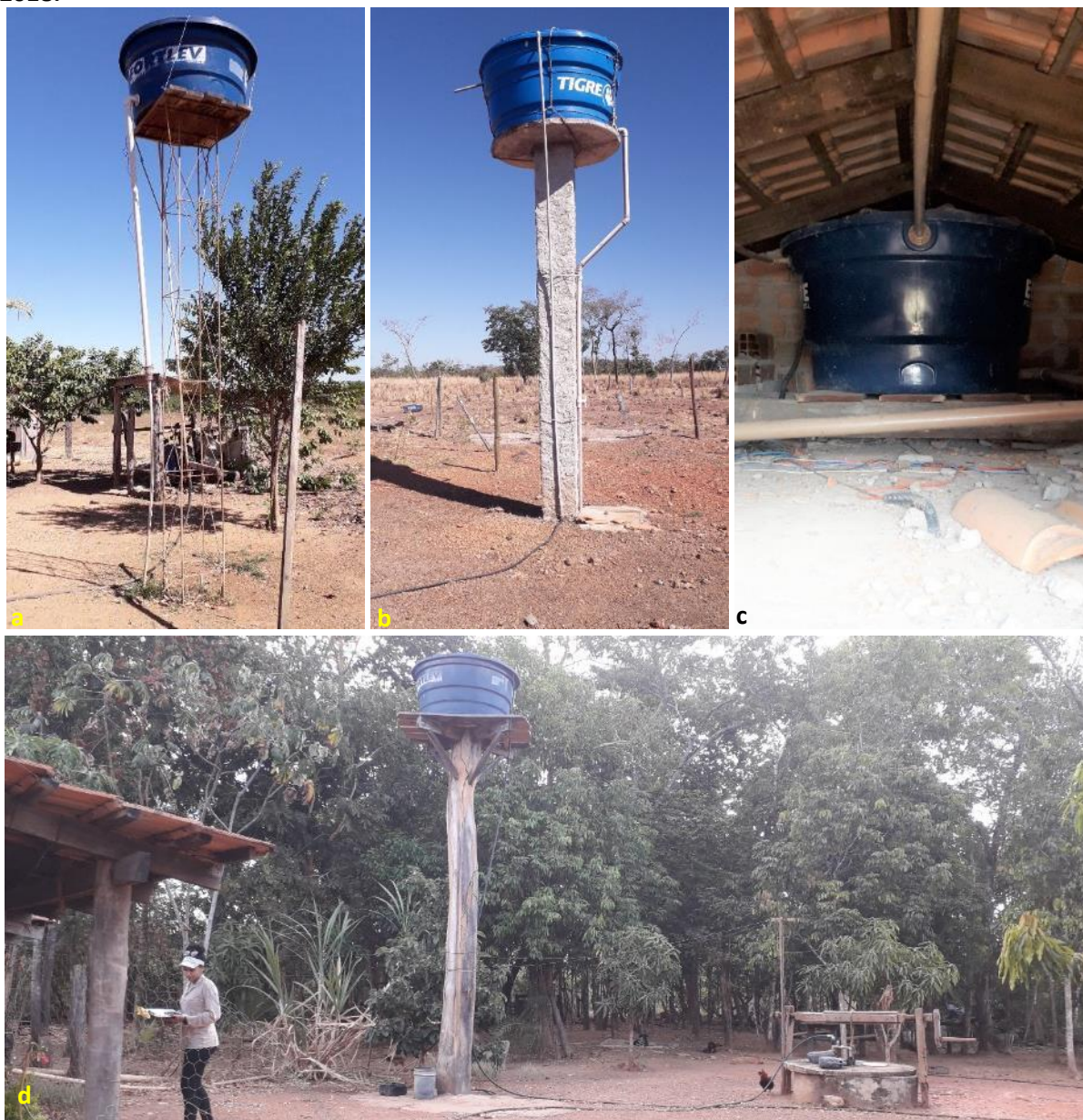
Foto 6.6 – Reservatório domiciliar instalado sobre estrutura metálica (a), em alvenaria (b), tábuas de madeira apoiadas nas vigas sobre a laje (c) e madeira (d), Comunidade Tatumã, Nova Crixás-GO, 2018.
