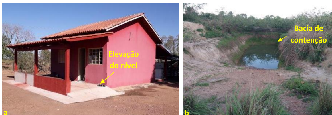
Foto 6.21 – Dispositivos de prevenção dos danos provocados pelas águas nas residências (a) e nos lotes (b) da Comunidade Tarumã, Nova Crixás-GO, 2018.
