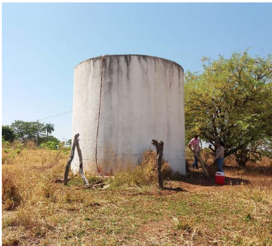
Foto 6.3 – Reservatório de distribuição do SAA, na Comunidade de Taquarussu, Campos Belos-GO, 2019.
