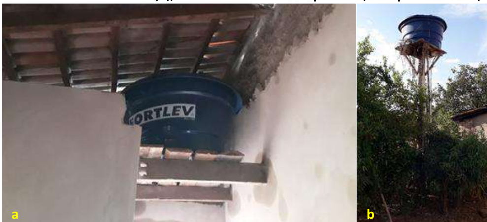
Foto 6.8 – Reservatório domiciliar instalado próximo ao telhado no interior de um domicílio (a) e outro sobre estrutura de madeira (b), na Comunidade de Taquarussu, Campos Belos-GO, 2019.
