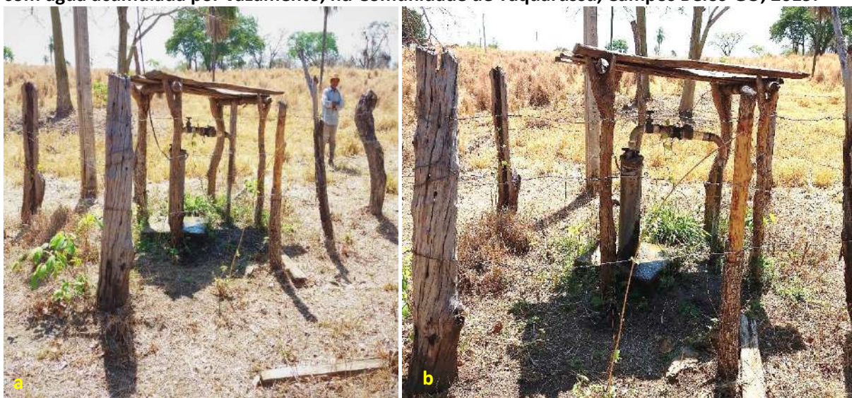
Foto 6.2 – Área de captação com poste de energia, cercas de isolamento e poço tubular profundo com água acumulada por vazamento, na Comunidade de Taquarussu, Campos Belos-GO, 2019.
