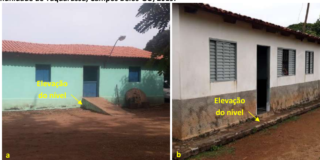
Foto 6.23 – Dispositivos de prevenção dos danos provocados pelas águas em residências da Comunidade de Taquarussu, Campos Belos-GO, 2019.
