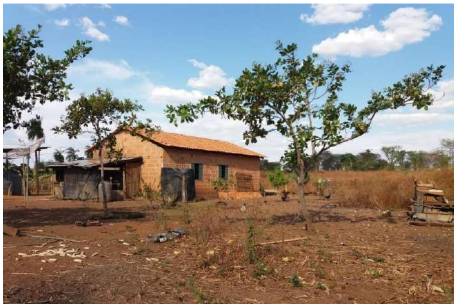
Foto 4.8 – Cobertura de telha de barro identificada na Comunidade de Taquarussu, Campos Belos-GO, 2019.
