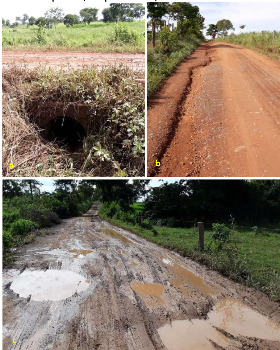
Foto 6.20 – Situação da drenagem pluvial: bueiro (a), processo erosivo (b) e pontos de alagamento (c) na Comunidade de Taquarussu, Campos Belos-GO, 2019.
