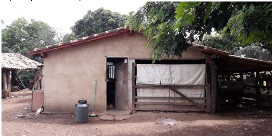
Foto 4.3 – Habitação construída de alvenaria com reboco sem pintura, identificada na Comunidade de Taquarussu, Campos Belos-GO, 2019.
