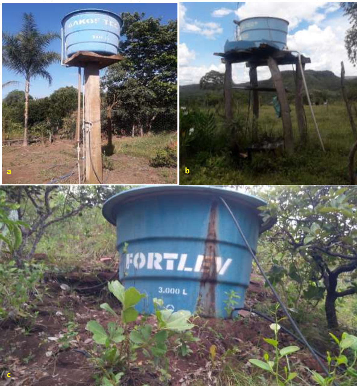
Foto 6.5 – Reservatórios em fibra de vidro, sobre um estrutura em concreto (a), sobre uma estrutura em madeira (b) e outro sobre o solo (c), na Comunidade Serra das Araras, Mineiros-GO, 2019.
