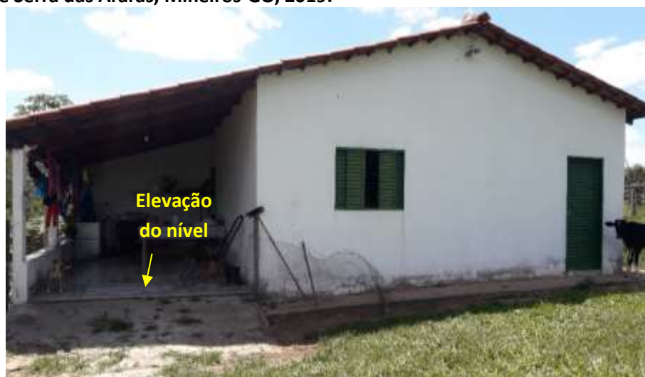
Foto 6.22 – Dispositivo de prevenção dos danos provocados pelas águas em residência da Comunidade Serra das Araras, Mineiros-GO, 2019.
