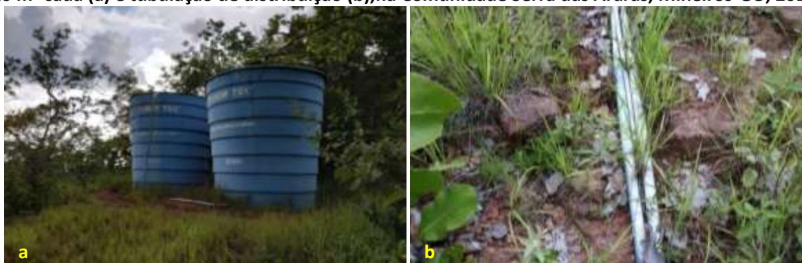
Foto 6.3 – Componentes do SAA, sistema de reservação - R1, constituído por dois reservatórios de 20 m 3 cada (a) e tubulação de distribuição (b), na Comunidade Serra das Araras, Mineiros-GO, 2019.
