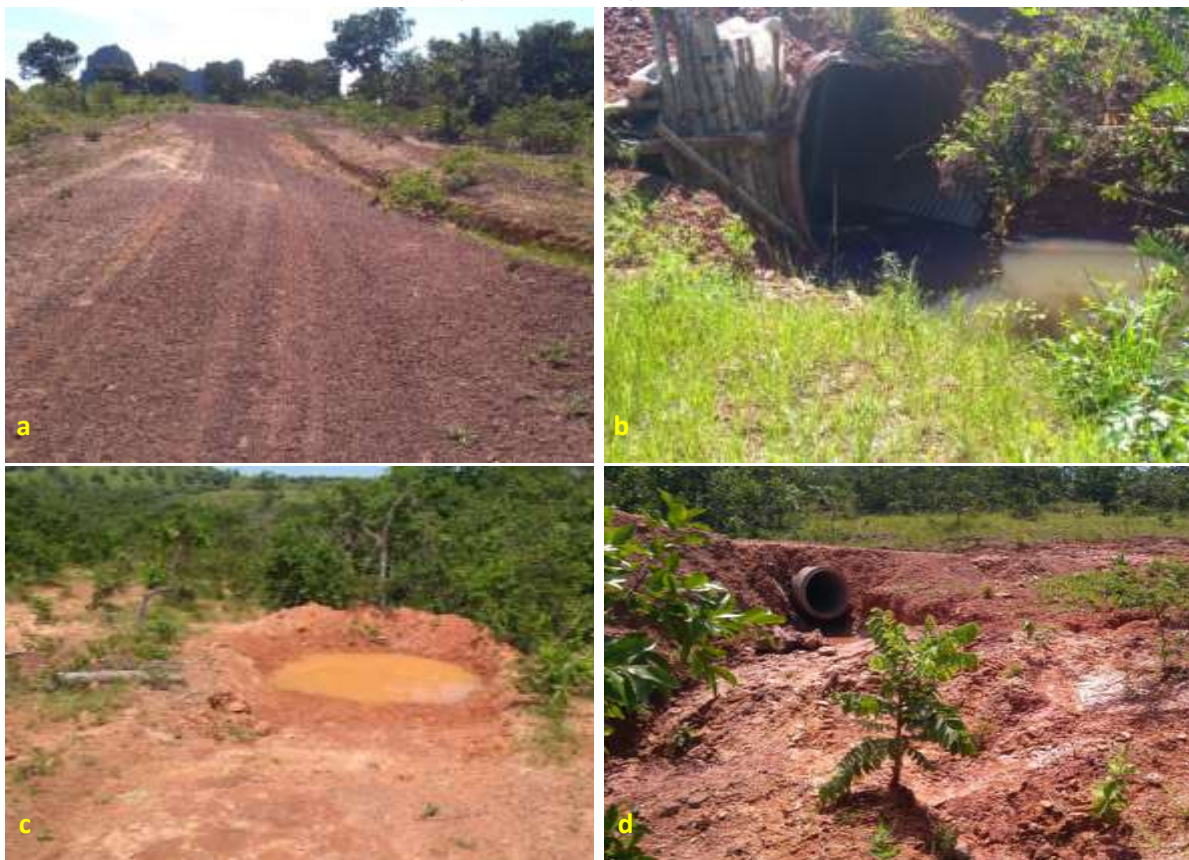
Foto 6.16 – Valeta (a), bueiro no córrego Sucuri (b), barraginha (c) e processo erosivo (d) na via de acesso à Comunidade Serra das Araras, Mineiros-GO, 2019.
