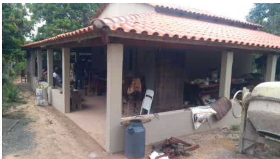
Foto 4.13 – Cobertura de telha de barro, identificada na Comunidade Serra das Araras, Mineiros-GO, 2019.
