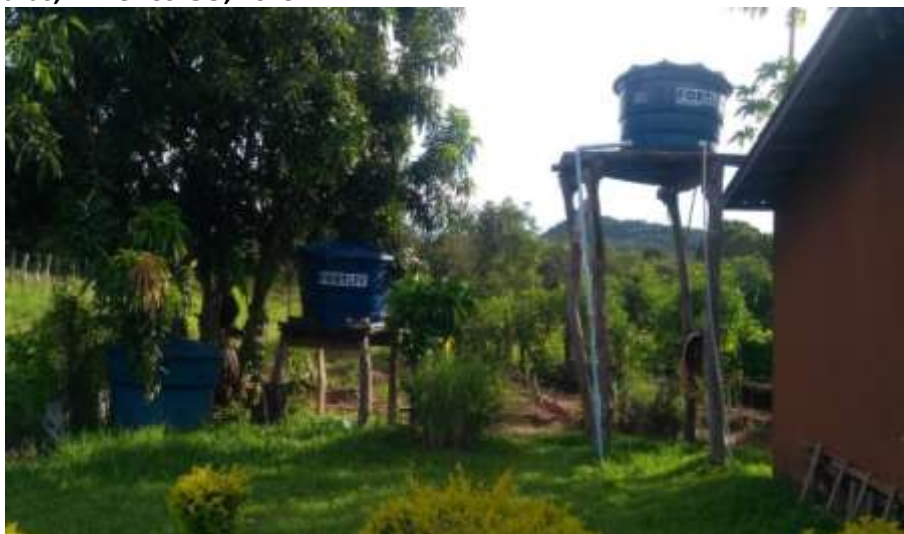
Foto 6.4 – Unidade familiar dotada de dois reservatórios domiciliares em polietileno, na Comunidade Serra das Araras, Mineiros-GO, 2019.
