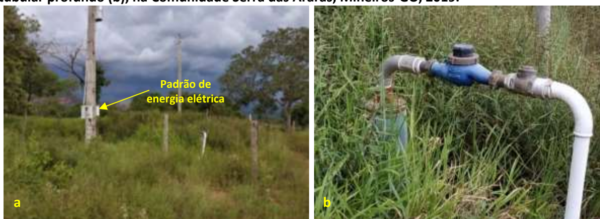
Foto 6.2 – Área de captação do SAA isolada por cerca, contendo um padrão de energia (a) e o poço tubular profundo-(b), na Comunidade Serra das Araras, Mineiros-GO, 2019.
