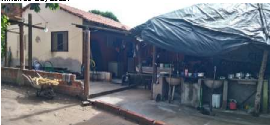
Foto 4.11 – Piso de residência constituído de cimento queimado, identificado na Comunidade Serra das Araras, Mineiros-GO, 2019.
