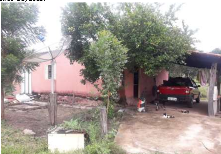
Foto 4.9 – Piso de residência constituído de concreto bruto, identificado na Comunidade Serra das Araras, Mineiros-GO, 2019.
