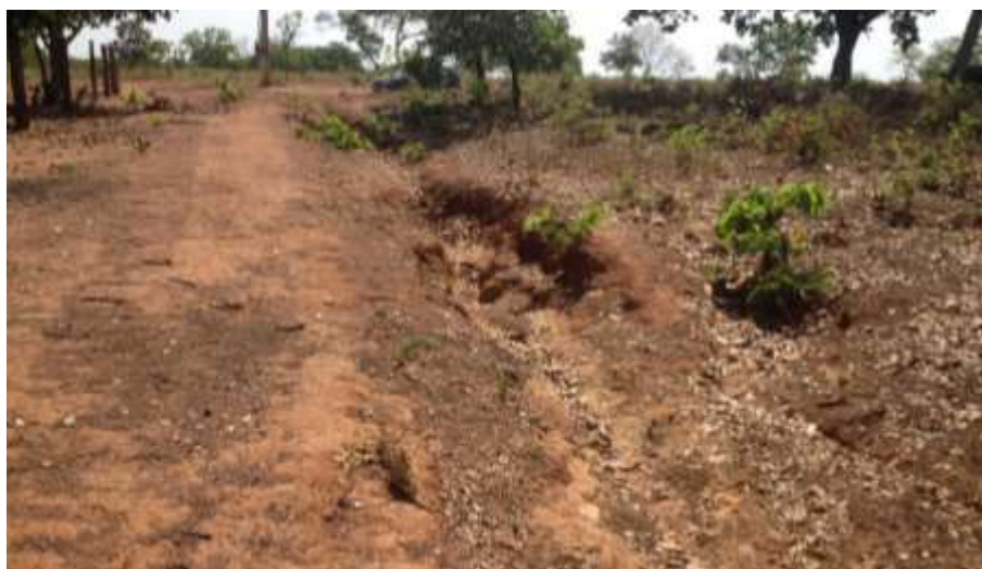
Foto 6.21 – Processo erosivo em lote da Comunidade São Thiago, Santa Rita do Novo Destino-GO, 2018.
