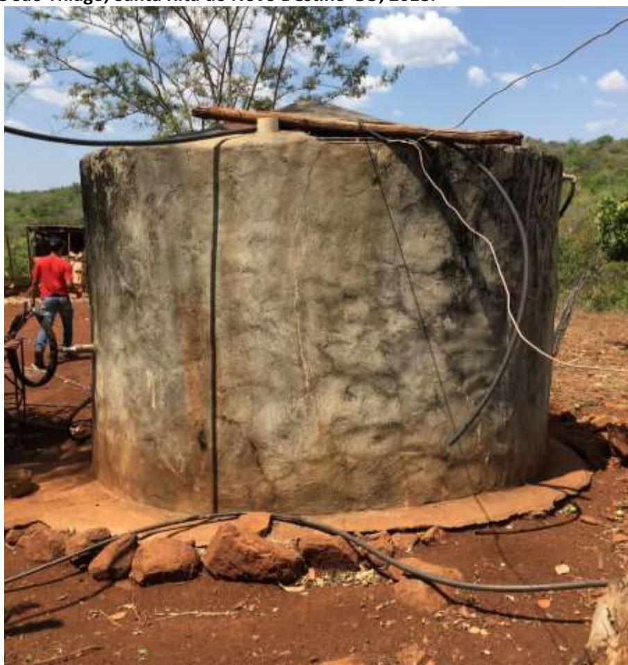
Foto 6.6 – Estrutura em concreto para armazenamento de água utilizada para regar plantas, na Comunidade São Thiago, Santa Rita do Novo Destino-GO, 2018.
