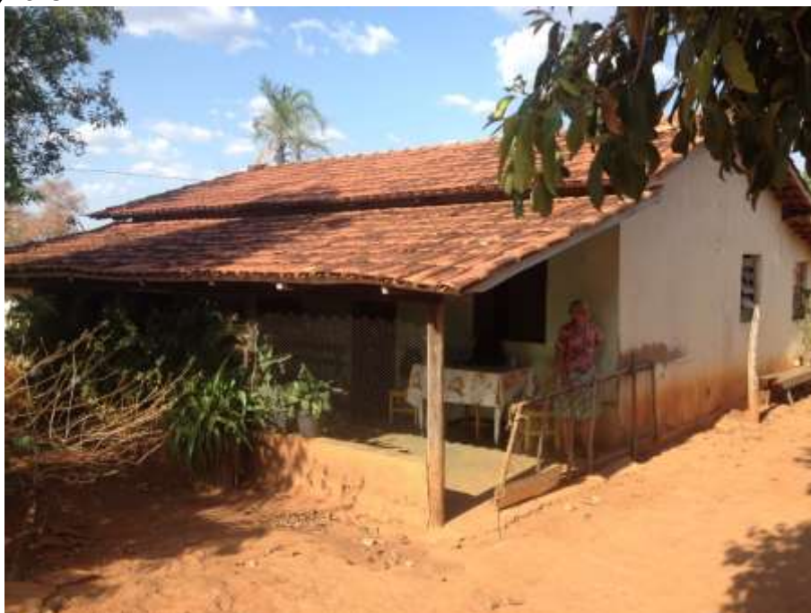
Foto 4.10 – Cobertura de telha de barro, identificada na Comunidade São Thiago, Santa Rita do Novo Destino-GO, 2018.
