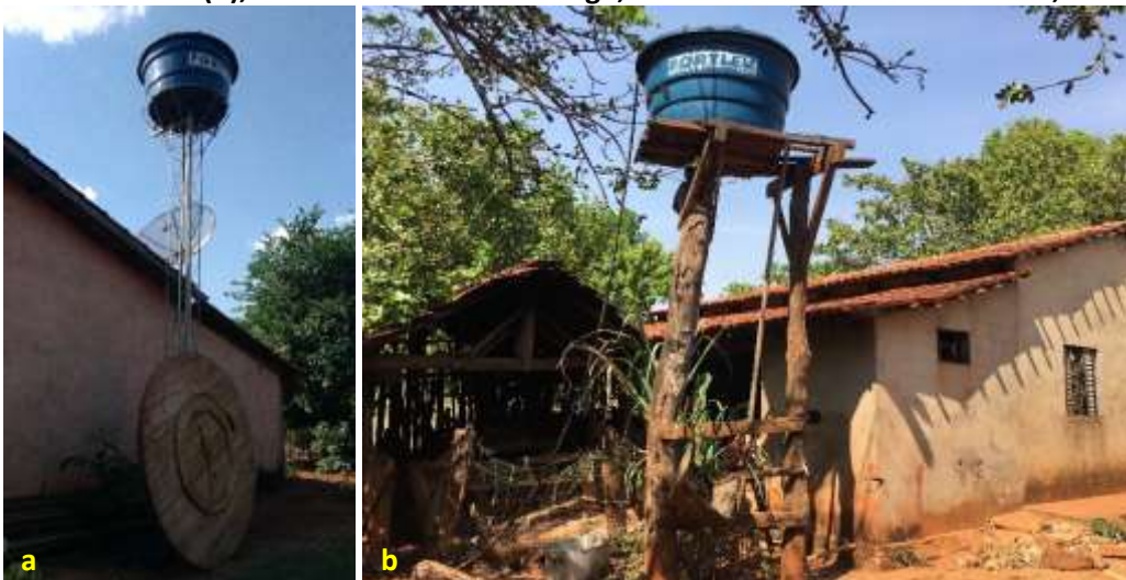
Foto 6.5 – Reservatório instalado sobre uma estrutura em material metálico (a), e outro sobre uma estrutura em madeira (b), na Comunidade São Thiago, Santa Rita do Novo Destino-GO, 2018.
