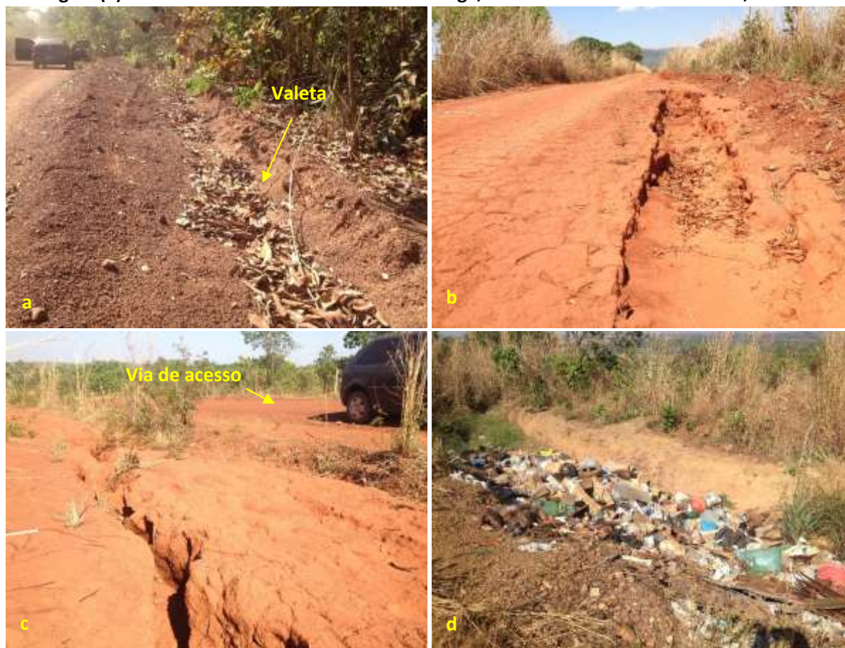
Foto 6.17 – Valeta (a), processos erosivos na via (b) e na margem (c) da via e ponto de resíduos sólidos na margem (d) da via de acesso à Comunidade São Thiago, Santa Rita do Novo Destino-GO, 2018.
