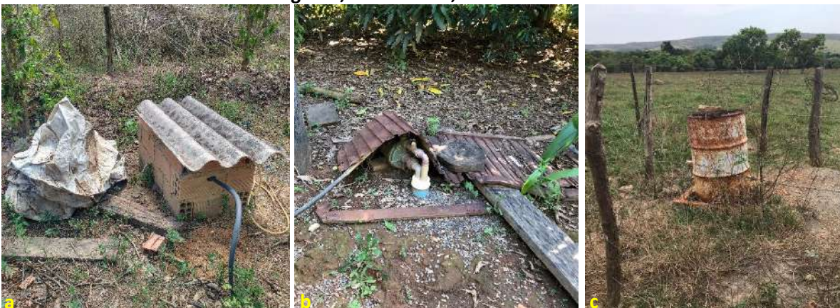
Foto 6.4 – Conjunto motobomba de poço tubular raso protegido por estrutura em alvenaria (a) e outro por um pedaço de porta de ferro (b), e poço tubular profundo protegido por tambor (c), na Comunidade São Sebastião da Garganta, Silvânia-GO, 2018.
