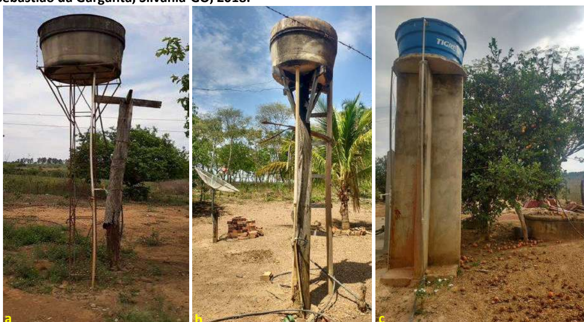
Foto 6.6 – Reservatórios de fibrocimento com tampa amarrada, instalados sobre estrutura metálica (a) de madeira (b) e reservatório de polietileno sobre estrutura de alvenaria (c), na Comunidade São Sebastião da Garganta, Silvânia-GO, 2018.
