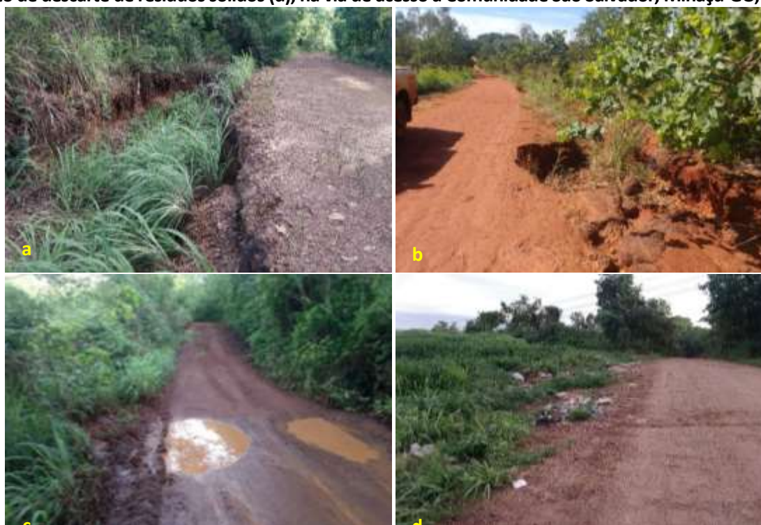
Foto 6.23 – Processos erosivos na margem da via de acesso (a) e na via (b), pontos de alagamento (c) e ponto de descarte de resíduos sólidos (d), na via de acesso à Comunidade São Salvador, Minaçu-GO, 2018.
