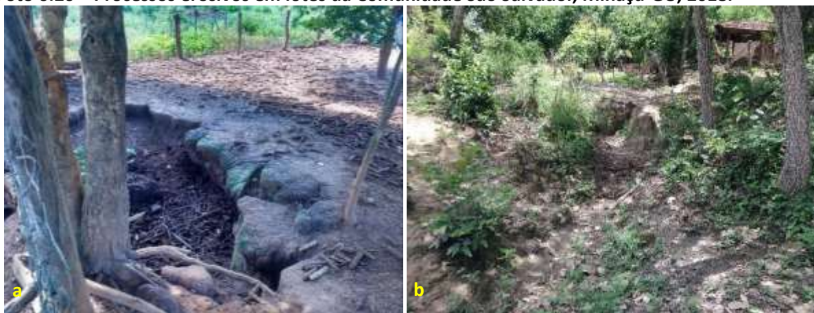
Foto 6.26 – Processos erosivos em lotes da Comunidade São Salvador, Minaçu-GO, 2018.
