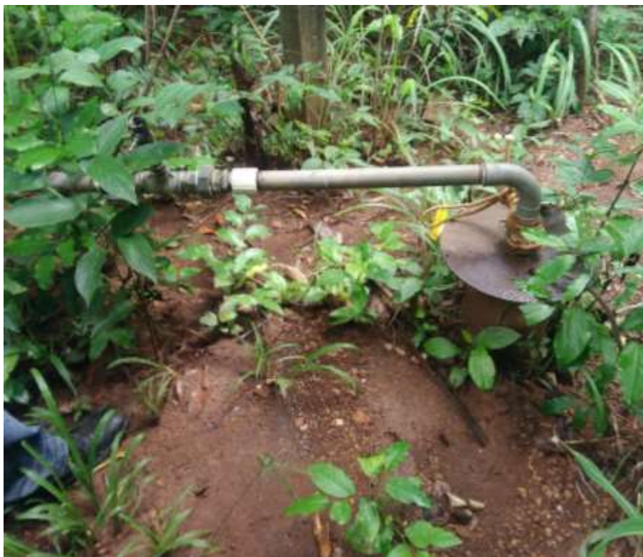
Foto 6.2 – Poço tubular profundo que atende o núcleo comunitário da Comunidade São Salvador, Minaçu-GO, 2018.
