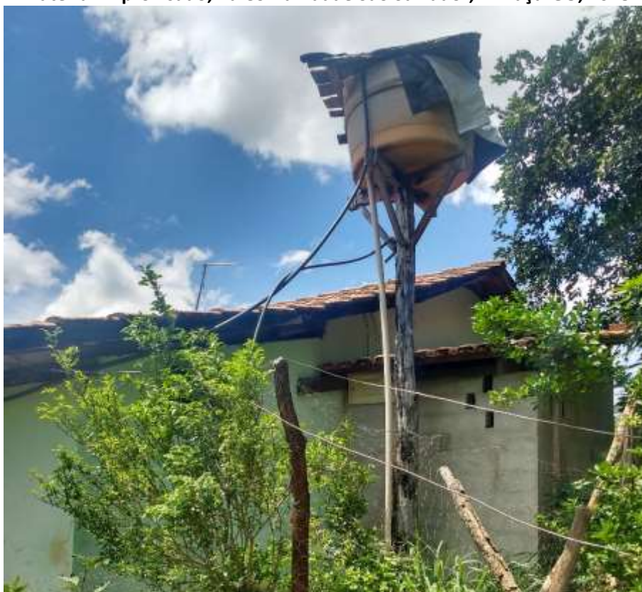
Foto 6.6 – Reservatório domiciliar em cimento amianto, apoiado em estrutura de madeira e tampado com material improvisado, na Comunidade São Salvador, Minaçu-GO, 2018.
