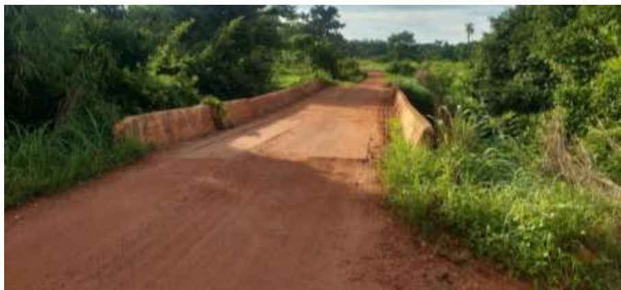
Foto 6.20 – Ponte sobre rio não identificado na via de acesso à Comunidade São Salvador, Minaçu-GO, 2018.
