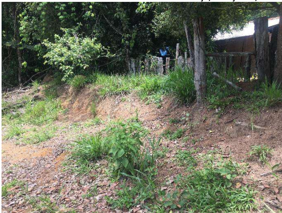
Foto 6.24 – Processo erosivo em lote da Comunidade São Lourenço, Uruaçu-GO, 2018.
