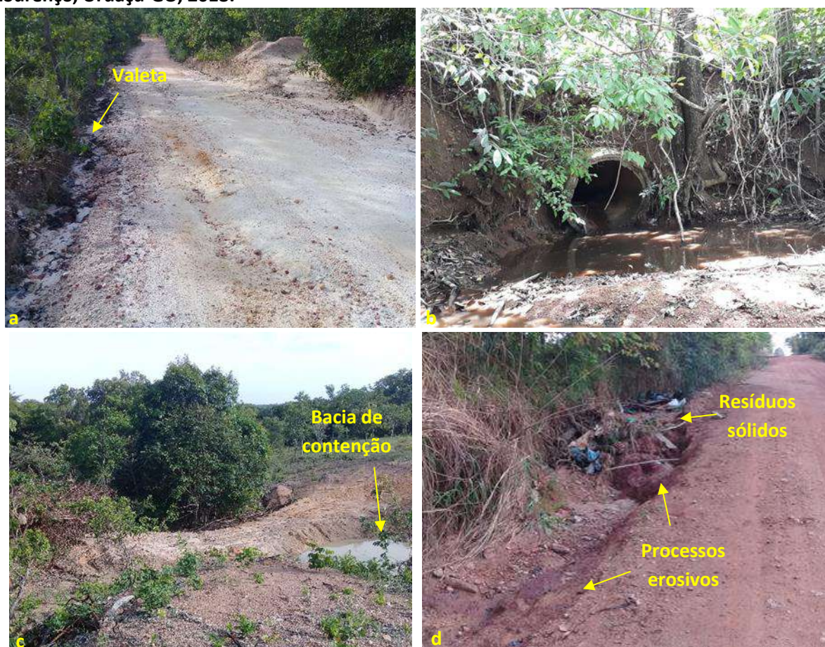
Foto 6.18 – Situação da drenagem pluvial na via de acesso: valeta de infiltração (a), bueiro (b), bacia de contenção (c) e processo erosivo (d) nas proximidades da via de acesso à Comunidade São Lourenço, Uruaçu-GO, 2018.
