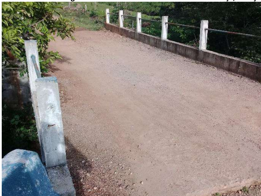
Foto 6.17 – Ponte sobre curso d'água na via de acesso à Comunidade São Lourenço, Uruaçu-GO, 2018.
