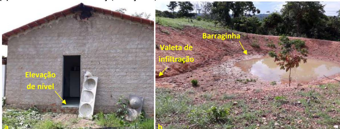
Foto 6.23 – Dispositivos de prevenção dos danos provocados pelas águas em residência (a) e lote (b) da Comunidade São Lourenço, Uruaçu-GO, 2018.
