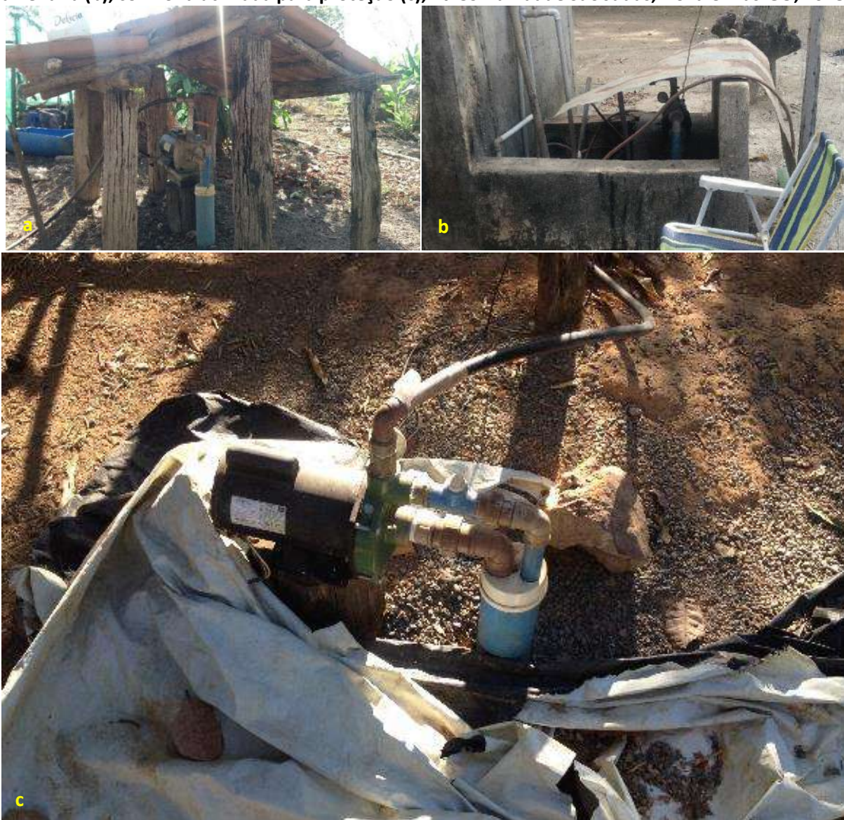
Foto 6.4 – Poço tubular raso em abrigo de madeira com cobertura em telhas (a) e em abrigo de alvenaria (b), com lona utilizada para proteção (c), na Comunidade São Judas, Nova Crixás-GO, 2018.
