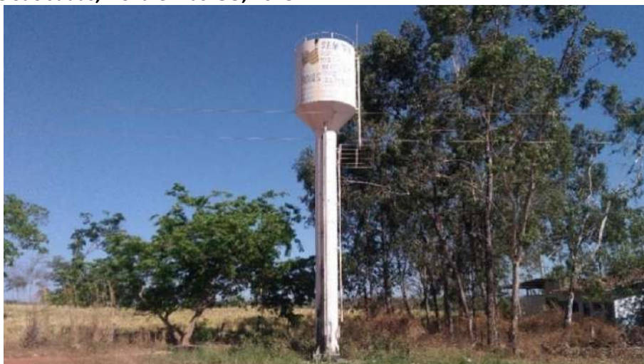
Foto 6.3 – Reservatório metálico do tipo taça, com capacidade de aproximadamente 5 m 3 , na Comunidade São Judas, Nova Crixás-GO, 2018.
