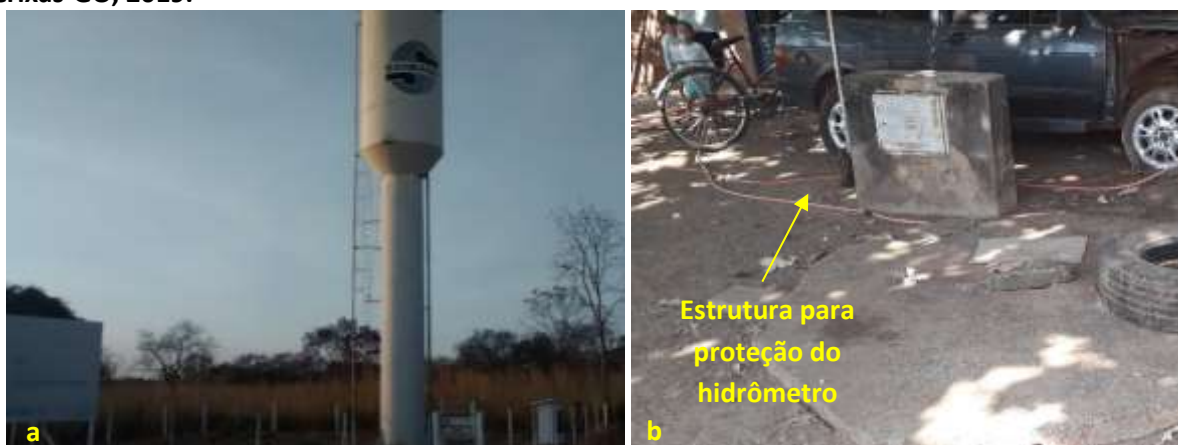
Foto 6.5 – Reservatório coletivo tipo taça, construído em material metálico e devidamente cercado e identificado (a), e estrutura de hidrometração (b), na Comunidade São José dos Bandeirantes, Nova Crixás-GO, 2019.
