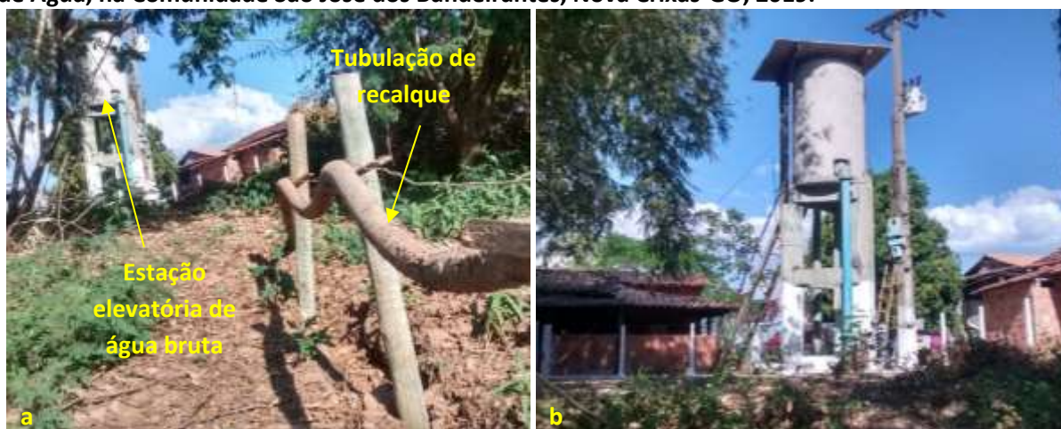
Foto 6.4 – Tubulação de sucção (a) e estação elevatória, cercada (b) pelo Sistema de Abastecimento de Água, na Comunidade São José dos Bandeirantes, Nova Crixás-GO, 2019.
