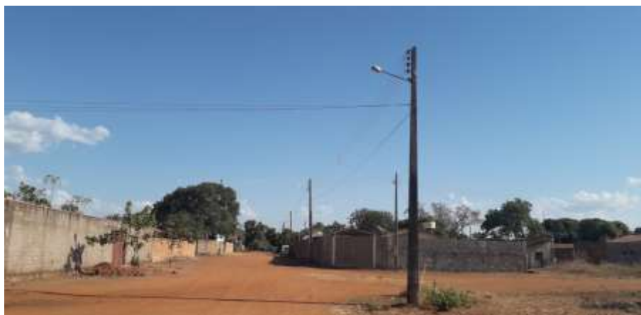
Foto 4.13 – Iluminação pública identificada na Comunidade São José dos Bandeirantes, Nova Crixás-GO, 2019.
