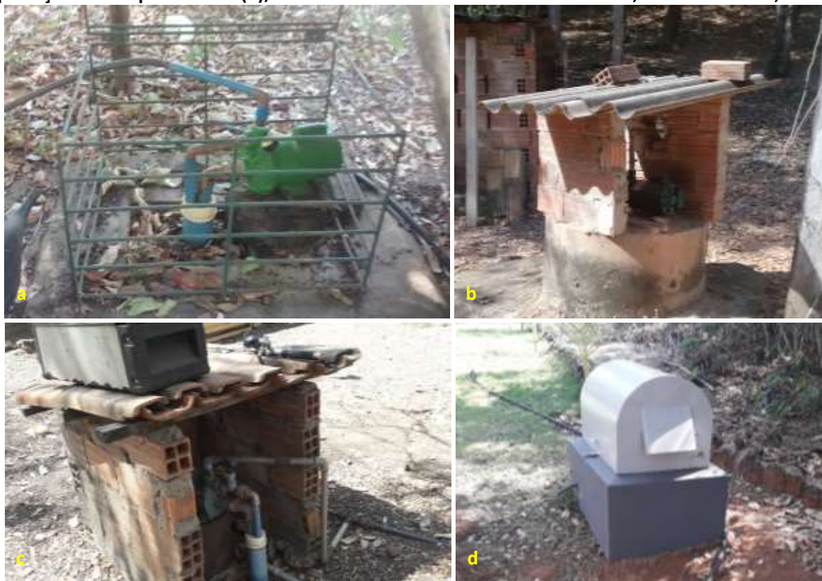
Foto 6.7 – Poços tubulares rasos cercados com abrigos metálicos (a), construído em alvenaria e com cobertura de telhado de fibrocimento (b) e telha cerâmica (c), sobre estrutura de alvenaria e proteção em chapa metálica (d), na Comunidade São José dos Bandeirantes, Nova Crixás-GO, 2019.
