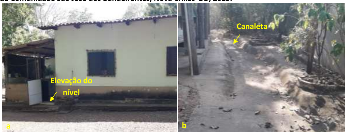
Foto 6.26 – Dispositivos de prevenção dos danos provocados pelas águas em residência (a) e lote (b) da Comunidade São José dos Bandeirantes, Nova Crixás-GO, 2019.
