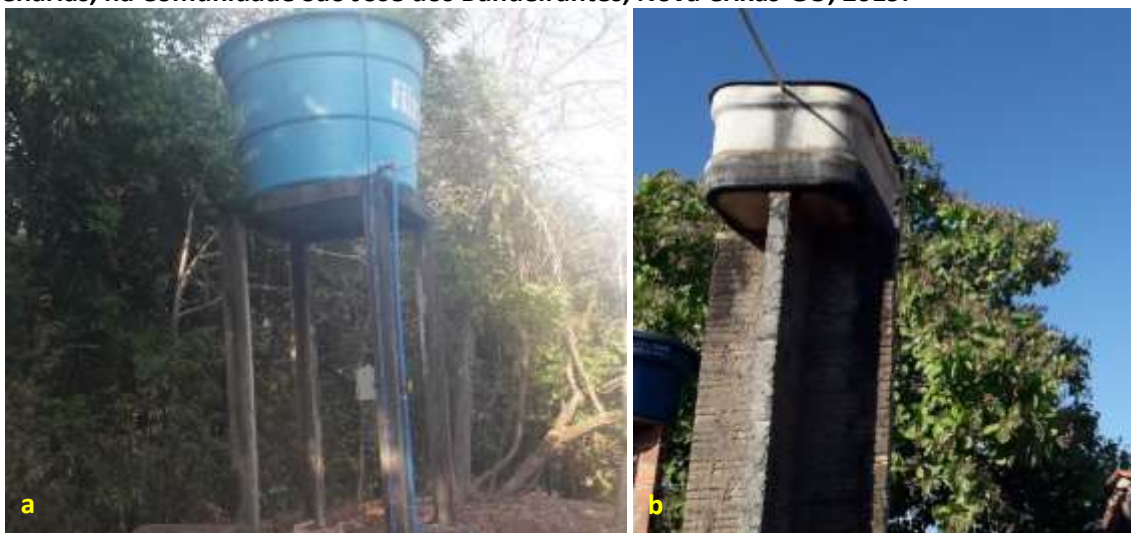
Foto 6.10 – Reservatório de fibra de vidro (a) e reservatório de fibrocimento (b) sobre estruturas de alvenarias, na Comunidade São José dos Bandeirantes, Nova Crixás-GO, 2019.
