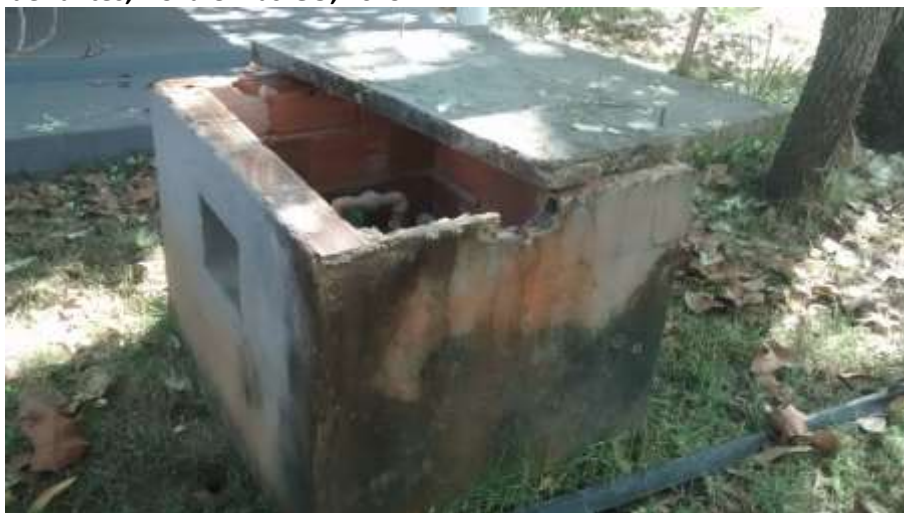
Foto 6.8 – Poço tubular profundo protegido por alvenaria e tampa de concreto na Comunidade São José dos Bandeirantes, Nova Crixás-GO, 2019.
