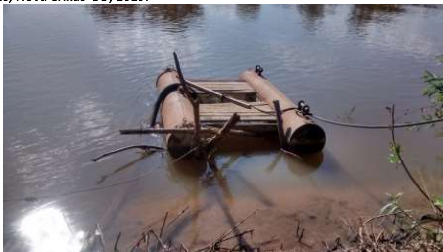
Foto 6.3 – Captação flutuante do Sistema de Abastecimento de Água, na Comunidade São José dos Bandeirantes, Nova Crixás-GO, 2019.
