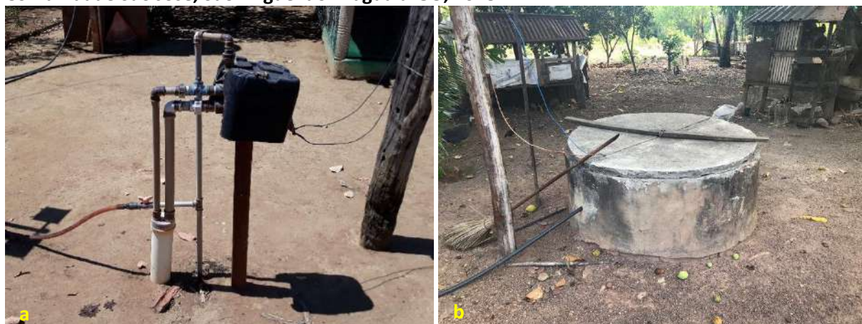
Foto 6.1 – Poço tubular raso (a) e poço raso escavado (b) utilizados como fonte de consumo na Comunidade São José, São Miguel do Araguaia-GO, 2018.
