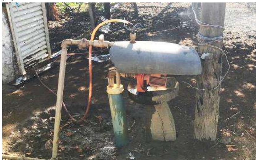
Foto 6.4 – Poço tubular raso coberto com material plástico, na Comunidade São José, São Miguel do Araguaia-GO, 2018.
