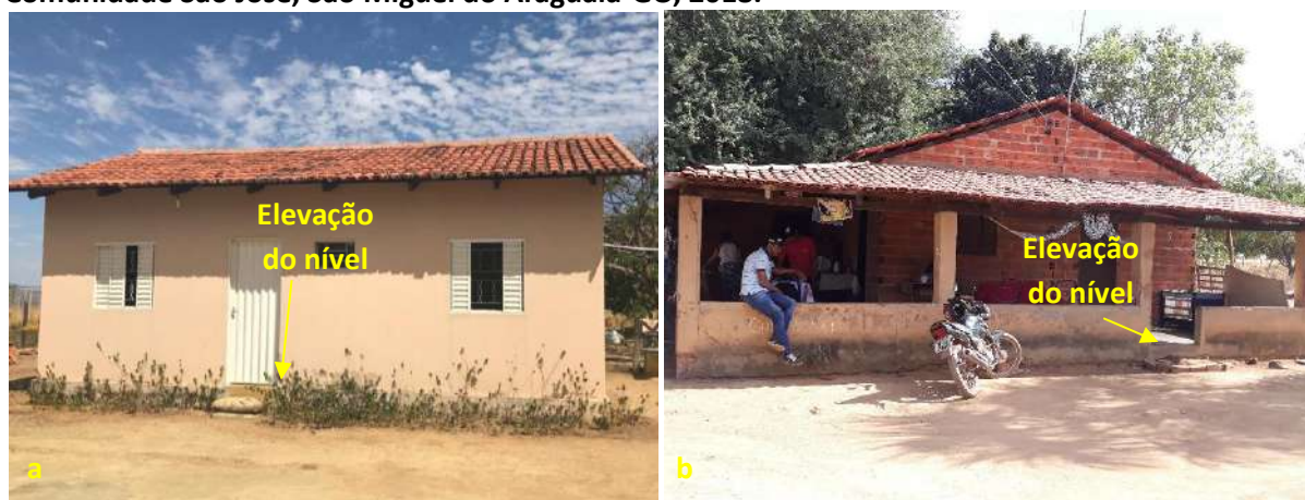
Foto 6.19 – Dispositivos de prevenção dos danos provocados pelas águas em residências da Comunidade São José, São Miguel do Araguaia-GO, 2018.
