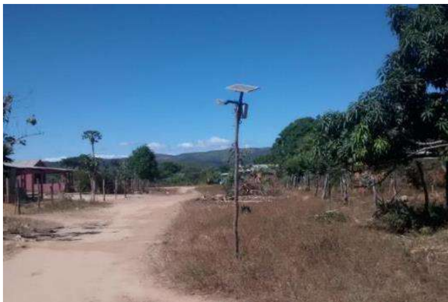
Foto 4.10 – Iluminação pública fotovoltaica identificada na Comunidade São Domingos, Cavalcante-GO, 2019.
