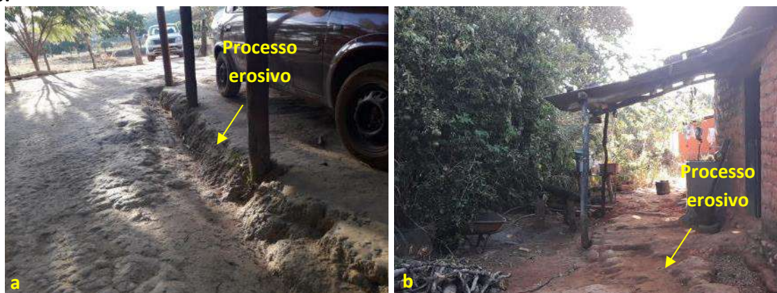
Foto 6.28 – Exemplos de processos erosivos em lotes da Comunidade São Domingos, Cavalcante-GO, 2019.
