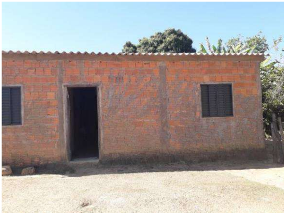
Foto 4.11 – Habitação construída de alvenaria sem reboco, identificada na Comunidade São Domingos, Cavalcante-GO, 2019.
