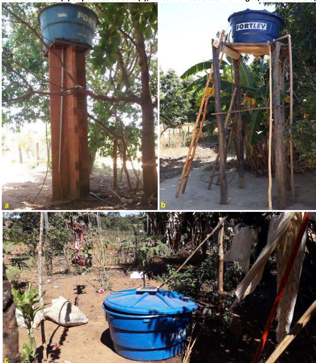
Foto 6.9 – Reservatórios domiciliares instalados sobre diferentes estruturas: reservatório de fibra de vidro instalado sobre estrutura de alvenaria (a), reservatórios de polietileno instalados sobre estrutura de madeira (b) e apoiados ao solo (c), na Comunidade São Domingos, Cavalcante-GO, 2019.
