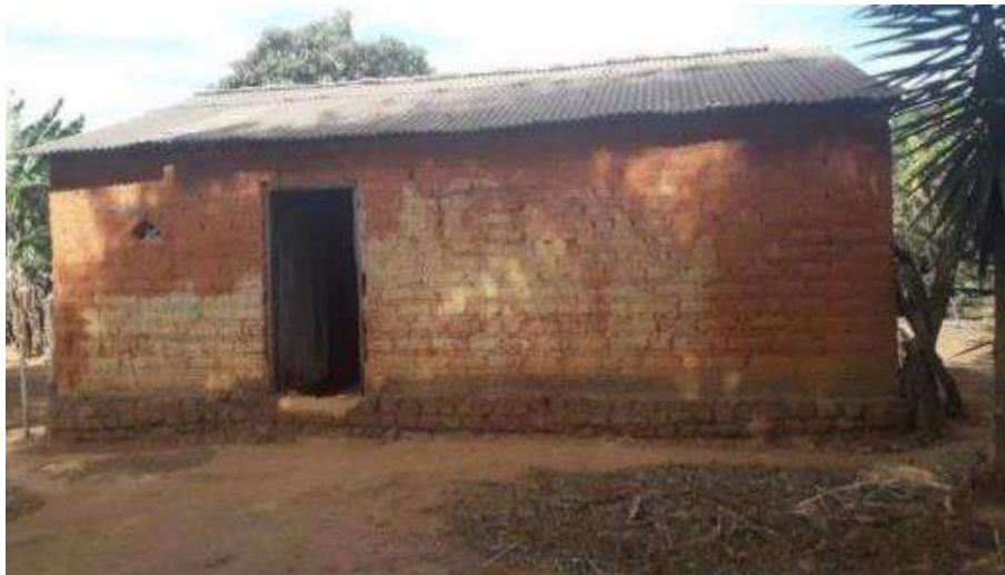
Foto 4.19 – Cobertura do tipo fibrocimento, identificada na Comunidade São Domingos, Cavalcante-GO, 2019.
