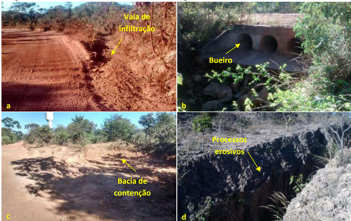
Foto 6.22 – Vala de infiltração (a), bueiro (b), bacia de contenção (c) e processos erosivos (d) nas margens da via de acesso à Comunidade São Domingos, Cavalcante-GO, 2019.
