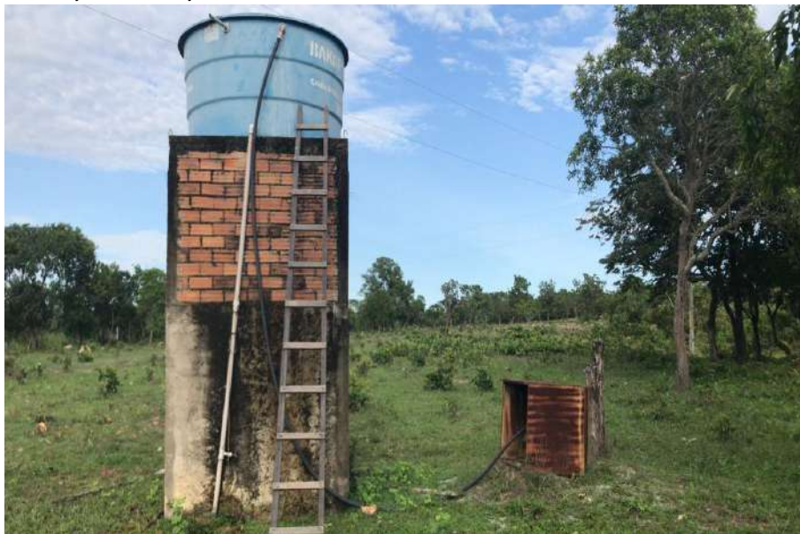
Foto 6.6 – Reservatório em fibra de vidro sobre estrutura de alvenaria (a), na Comunidade Santo Antônio das Areias, Faina-GO, 2018.
