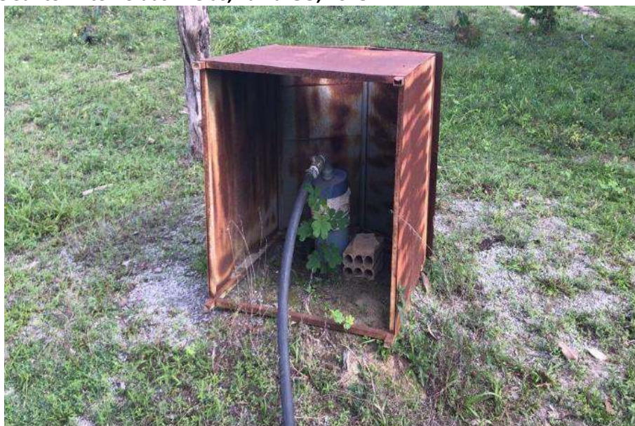
Foto 6.4 – Poço tubular profundo protegido por uma estrutura metálica improvisada, na Comunidade Santo Antônio das Areias, Faina-GO, 2018.
