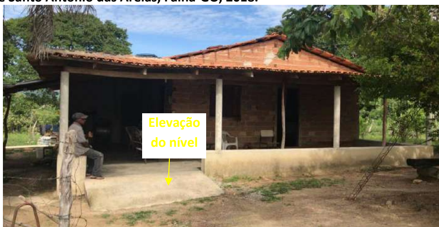
Foto 6.20 – Dispositivo de prevenção dos danos provocados pelas águas em residência da Comunidade Santo Antônio das Areias, Faina-GO, 2018.
