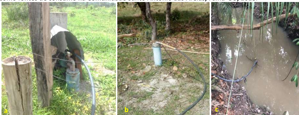
Foto 6.1 – Poço tubular raso (a), poço tubular profundo (b) e manancial superficial (c), utilizados como fontes de consumo na Comunidade Santo Antônio das Areias, Faina-GO, 2018.
