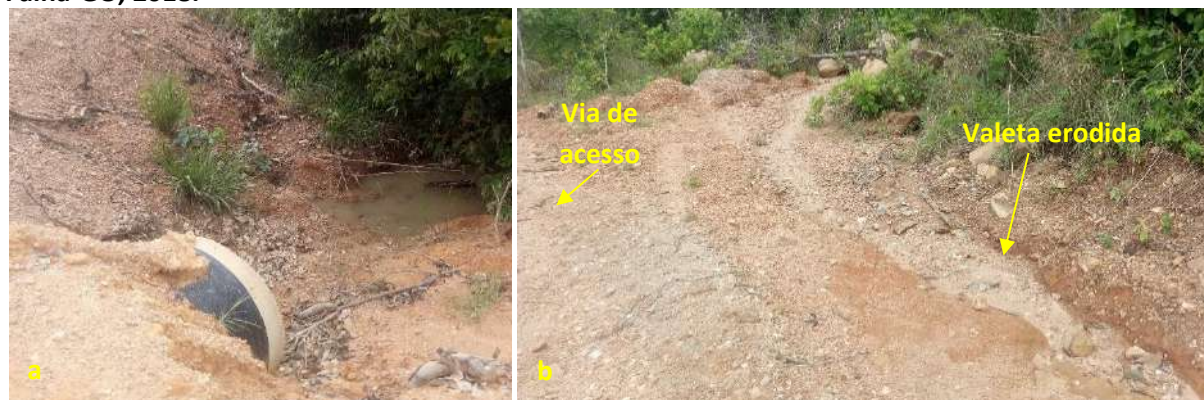
Foto 6.15 – Bueiro (a) e valeta erodida (b) na via de acesso à Comunidade Santo Antônio das Areias, Faina-GO, 2018.
