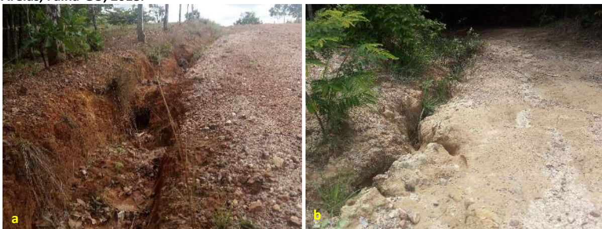
Foto 6.16 – Processos erosivos nas margens da via de acesso à Comunidade Santo Antônio das Areias, Faina-GO, 2018.
