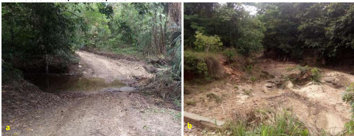
Foto 6.18 – Córrego das Areias (a) e córrego Taquaral (b) na via de acesso à Comunidade Santo Antônio das Areias, Faina-GO, 2018.
