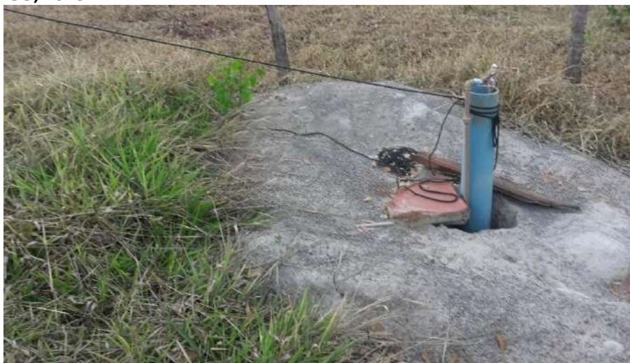
Foto 6.3 – Poço tubular profundo sem estruturas de proteção, na Comunidade Santa Rita do Broeiro, Niquelândia-GO, 2018.
