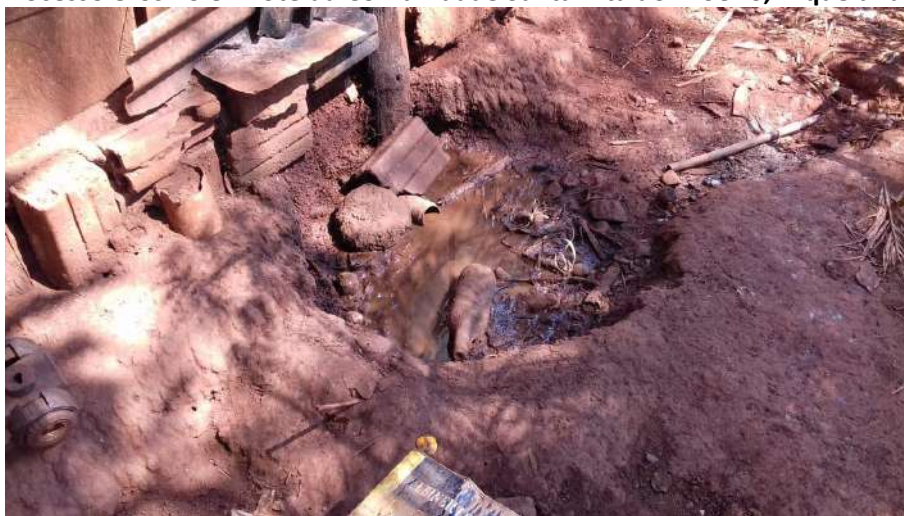
Foto 6.22 – Processo erosivo em lote da Comunidade Santa Rita do Broeiro, Niquelândia-GO, 2018.
