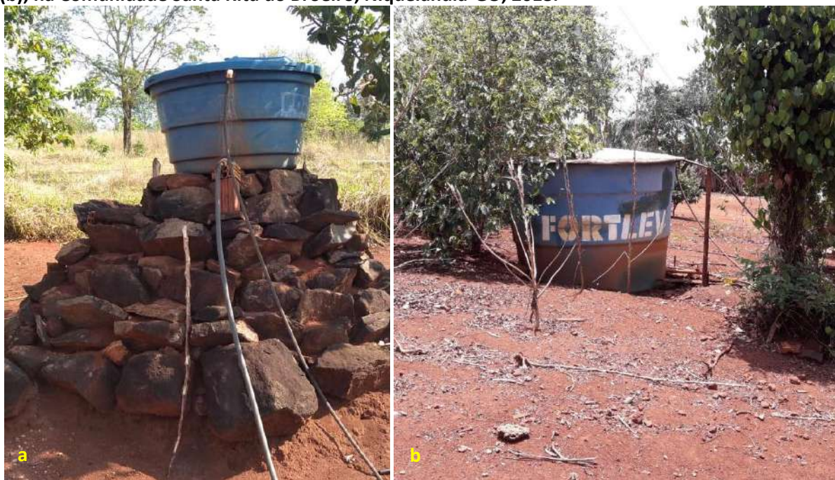
Foto 6.6 – Reservatório em polietileno sobre pedras (a) e reservatório em fibra de vidro sobre o solo (b), na Comunidade Santa Rita do Broeiro, Niquelândia-GO, 2018.
