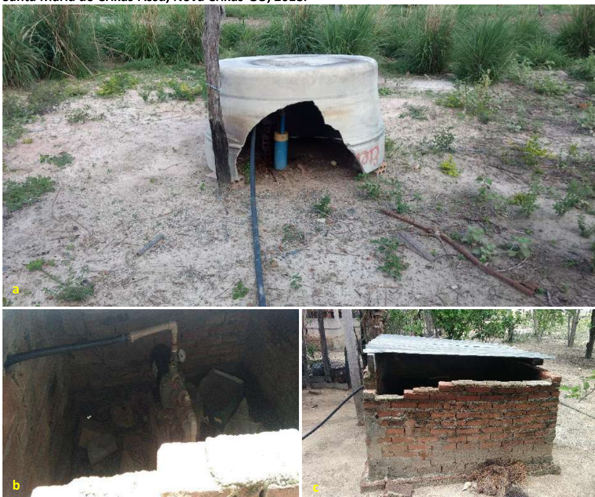
Foto 6.3 – Poço tubular raso protegido por um reservatório de fibrocimento de forma improvisada (a) e outro por uma estrutura em alvenaria (b) coberto por telha de fibrocimento, na Comunidade Santa Maria do Crixás-Assú, Nova Crixás-GO, 2018.
