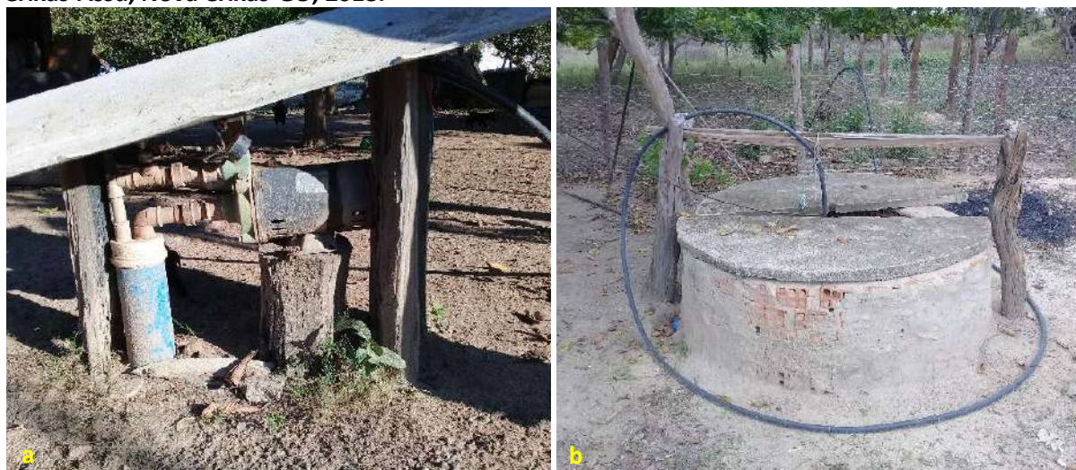
Foto 6.1 – Poço tubular raso (a) e poço raso escavado (b) utilizados na Comunidade Santa Maria do Crixás-Assú, Nova Crixás-GO, 2018.
