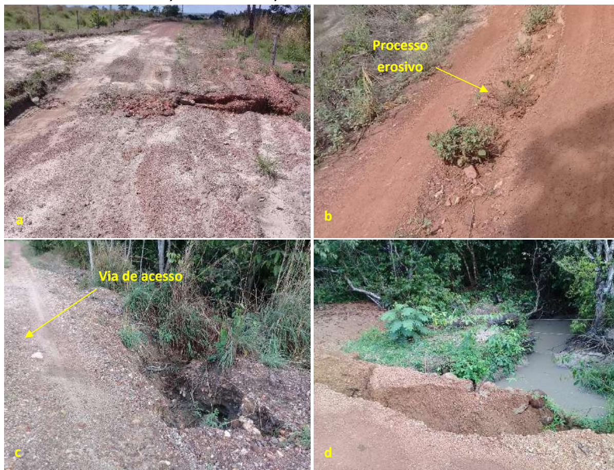
Foto 6.16 – Processos erosivos na via (a) (b) e nas margens da via de acesso (c) e (d) à Comunidade Santa Maria do Crixás-Assú, Nova Crixás-GO, 2018.
