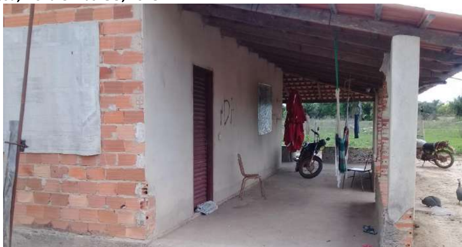
Foto 4.9 – Piso de residência constituído de concreto bruto, identificado na Comunidade Santa Maria do Crixás-Assú, Nova Crixás-GO, 2018.
