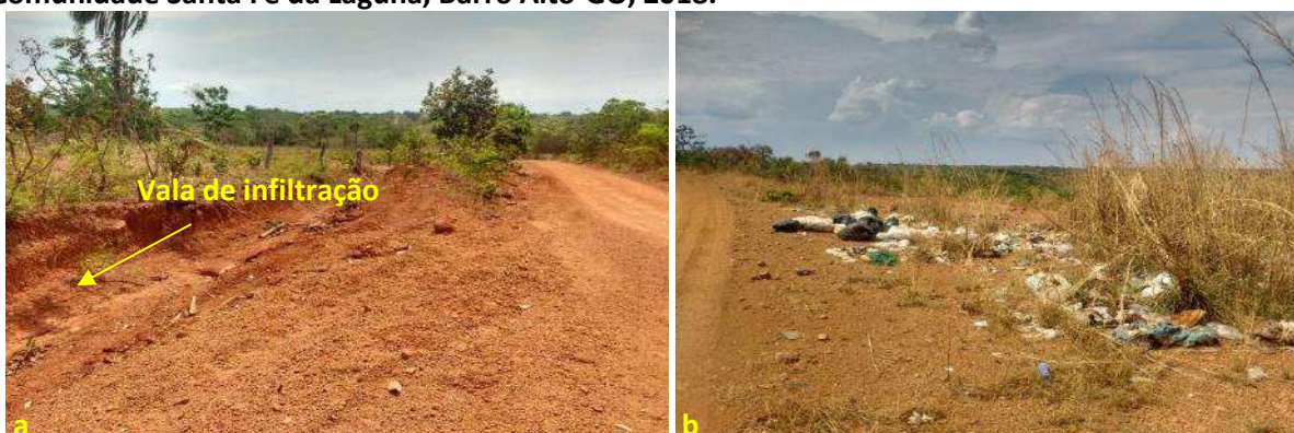
Foto 6.21 – Vala de infiltração (a) e depósito de resíduos sólidos (b) às margens da via de acesso à Comunidade Santa Fé da Laguna, Barro Alto-GO, 2018.
