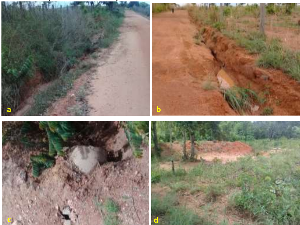
Foto 6.16 – Valetas erodidas (a), (b), bueiro (c) e vala de infiltração (d) na via de acesso à Comunidade Salto para o Futuro, Niquelândia-GO, 2018.
