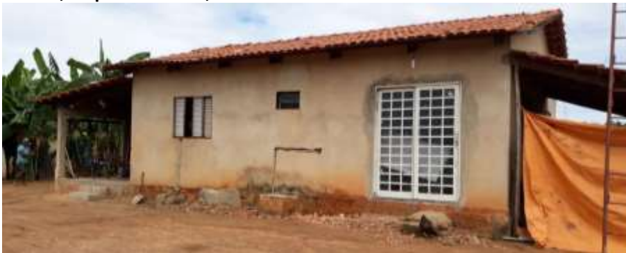
Foto 4.4 – Habitação construída de alvenaria com reboco sem pintura, identificada na Comunidade Salto para o Futuro, Niquelândia-GO, 2018.
