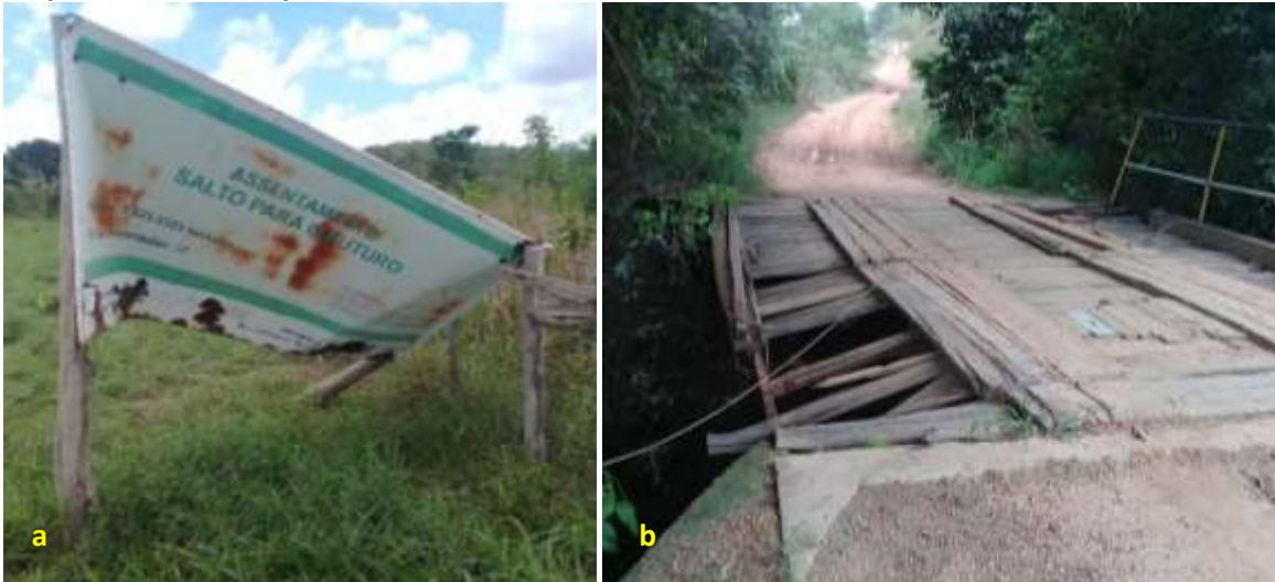
Foto 6.15 – Placa sinalizando a comunidade (a) e ponte quebrada (b) na via de acesso à Comunidade Salto para o Futuro, Niquelândia-GO, 2018.
