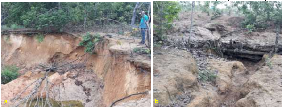
Foto 6.21 – Processos erosivos em lotes da Comunidade Salto para o Futuro, Niquelândia-GO, 2018.
