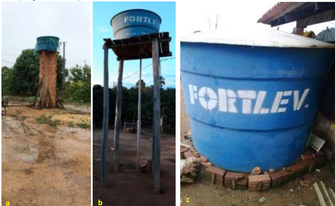
Foto 6.6 – Reservatórios de fibra de vidro instalados sobre estrutura em alvenaria (a), sobre estrutura em madeira (b) e outro apoiado diretamente no solo (c), na Comunidade Salto para o Futuro, Niquelândia-GO, 2018.
