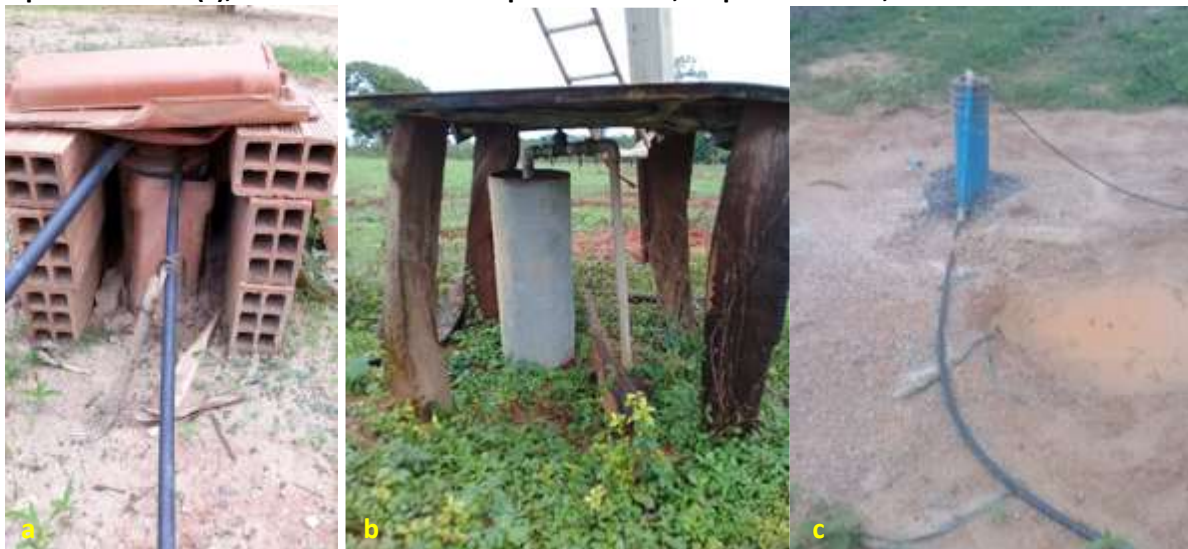
Foto 6.3 – Poço tubular profundo em abrigo construído com materiais improvisados (a e b) e outro exposto ao solo (c), na Comunidade Salto para o Futuro, Niquelândia-GO, 2018.
