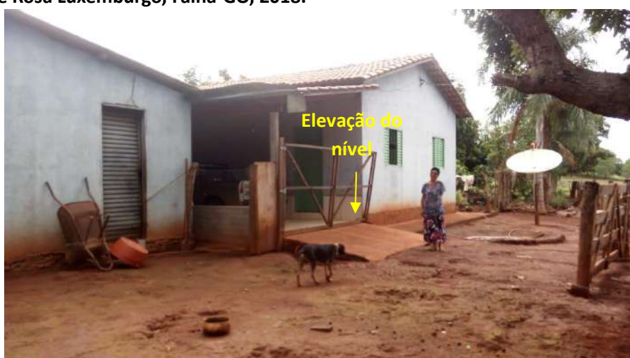
Foto 6.19 – Dispositivo de prevenção dos danos provocados pelas águas em residência da Comunidade Rosa Luxemburgo, Faina-GO, 2018.
