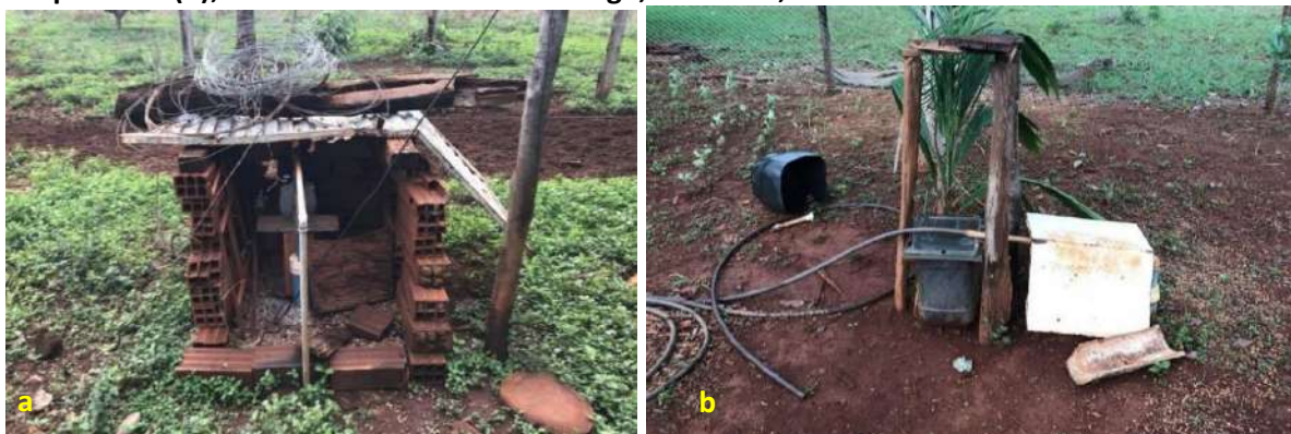
Foto 6.2 – Poços tubulares rasos protegidos em estrutura de alvenaria (a) e por chapas de compensado (b); Comunidade Rosa Luxemburgo, Faina-GO, 2018.
