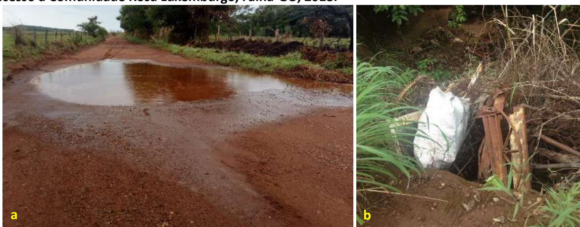
Foto 6.15 – Ponto de alagamento na via (a) e resíduos sólidos descartados (b) na margem da via de acesso à Comunidade Rosa Luxemburgo, Faina-GO, 2018.
