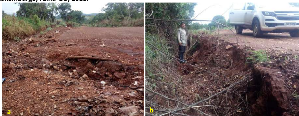
Foto 6.14 – Processos erosivos na via (a) e na margem da via (b) de acesso à Comunidade Rosa Luxemburgo, Faina-GO, 2018.
