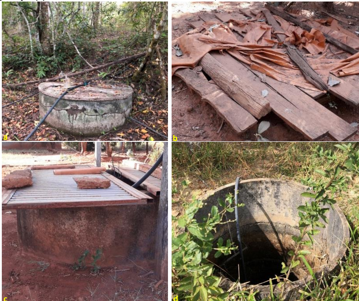
Foto 6.3 – Diferentes aspectos construtivos dos poços escavados: com tampa e mureta de proteção (a), com tampa feita em material improvisado (madeira e lona) e sem mureta de proteção (b), com tampa feita em material improvisado como porta metálica e tijolos (c) e sem tampa com mureta de proteção (d) na Comunidade Rochedo, Professor Jamil-GO, 2018.
