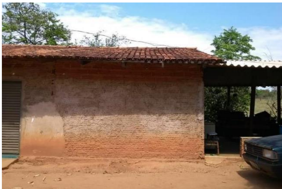
Foto 4.7 – Cobertura do tipo fibrocimento, identificada na Comunidade Rochedo, Professor Jamil-GO, 2018.
