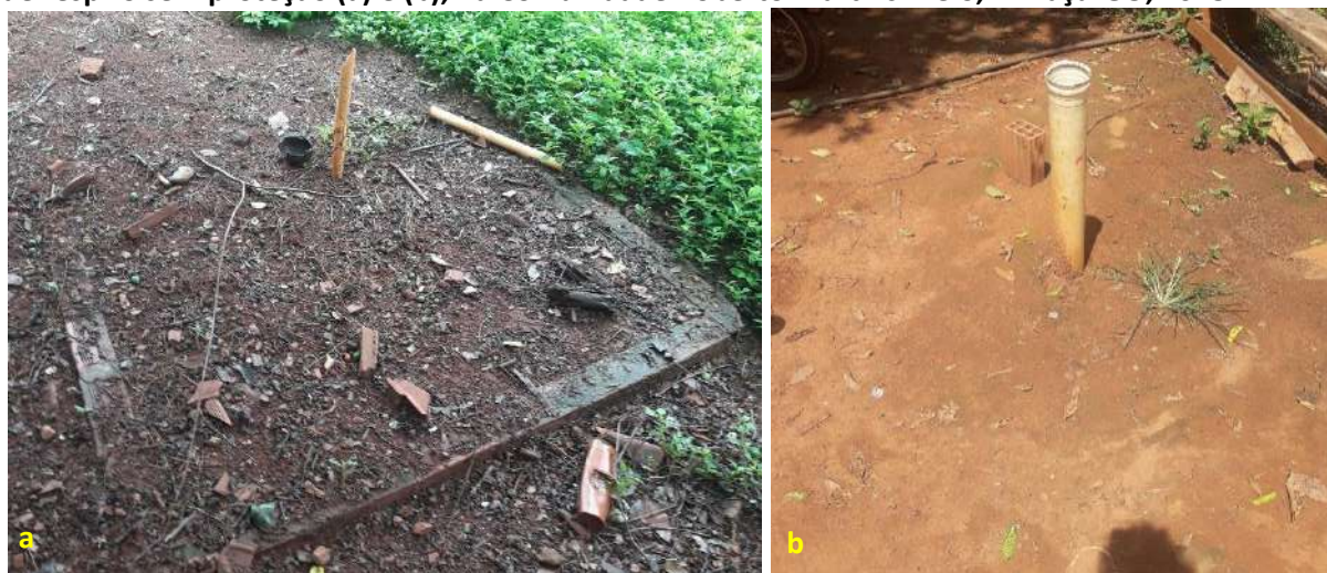
Foto 6.4 – Situações construtivas das fossas negras/rudimentares, com tampa sob o solo e tubulação de respiro sem proteção (a) e (b), na Comunidade Roberto Martins Melo, Minaçu-GO, 2018.
