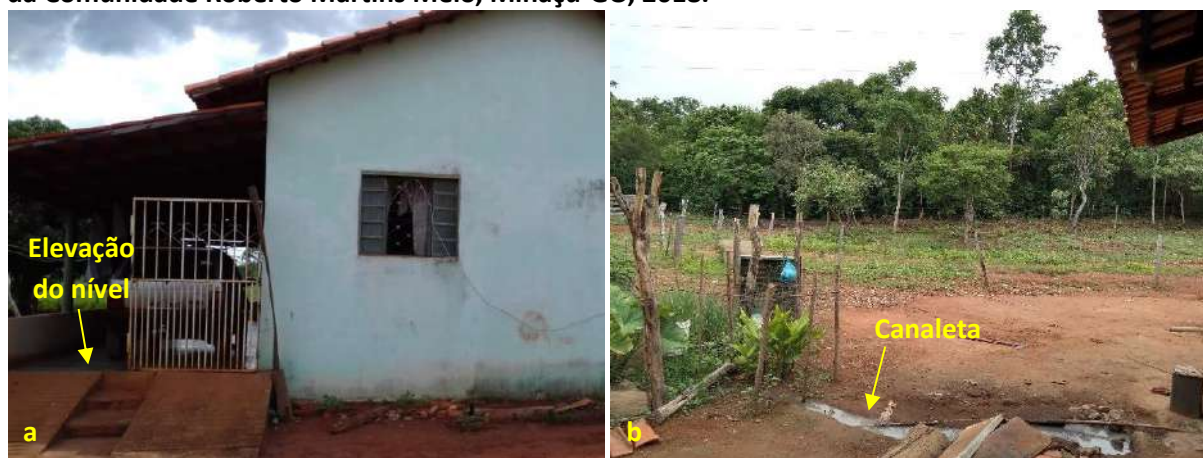
Foto 6.21 – Dispositivos de prevenção dos danos provocados pelas águas em residência (a) e lote (b) da Comunidade Roberto Martins Melo, Minaçu-GO, 2018.
