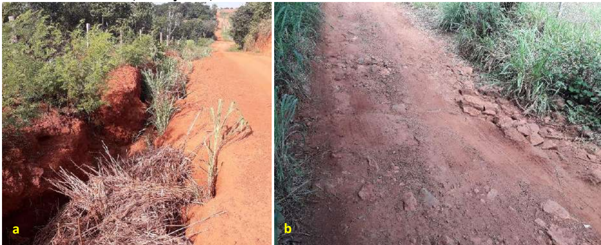
Foto 6.17 – Processo erosivo na via (a) e no ponto de alagamento (b), na via de acesso à Comunidade Roberto Martins Melo, Minaçu-GO, 2018.
