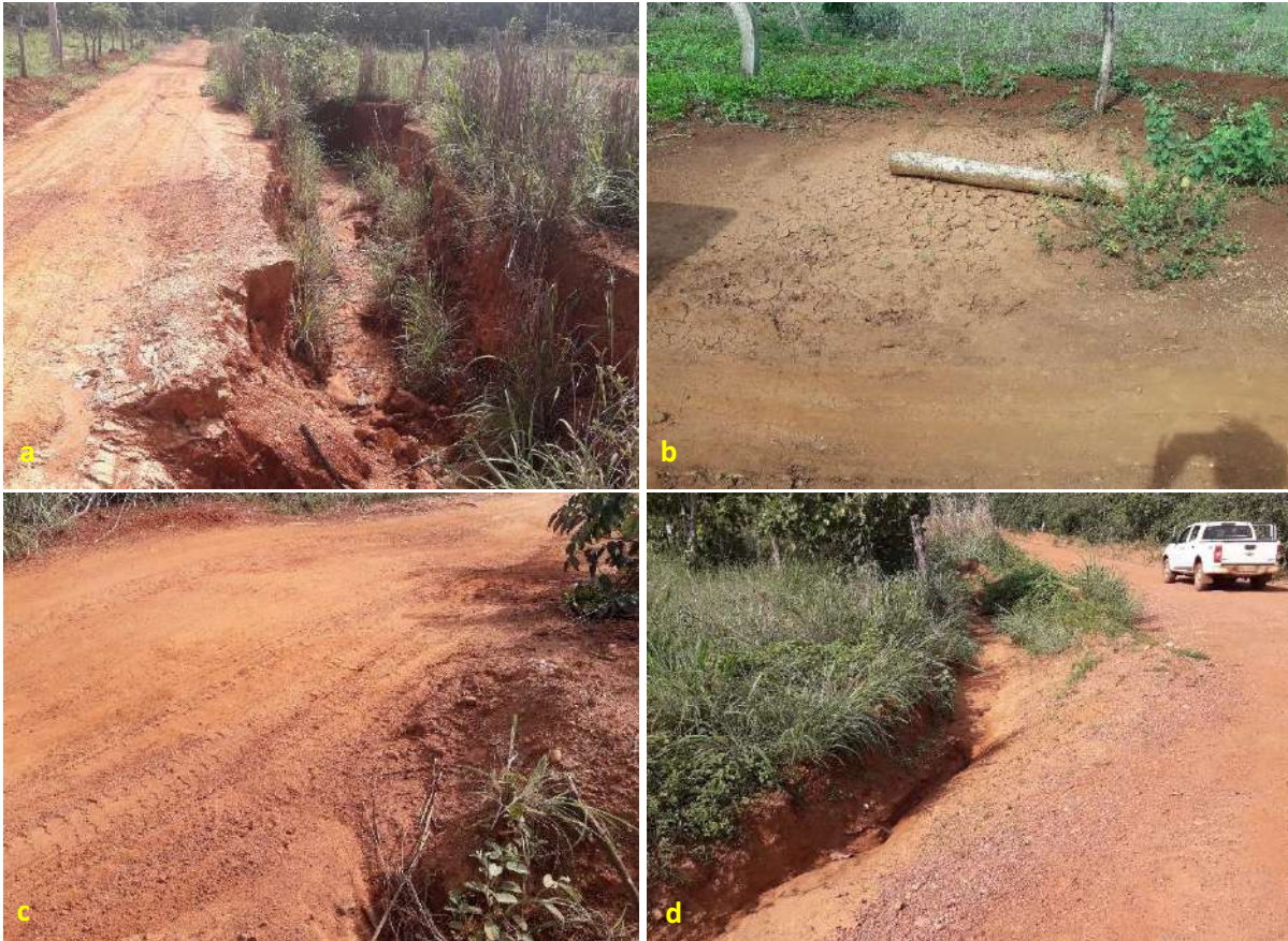
Foto 6.16 – Vala erodida (a), bacia de contenção (b), curva de nível (c) e valeta (d), na via de acesso à Comunidade Roberto Martins Melo, Minaçu-GO, 2018.
