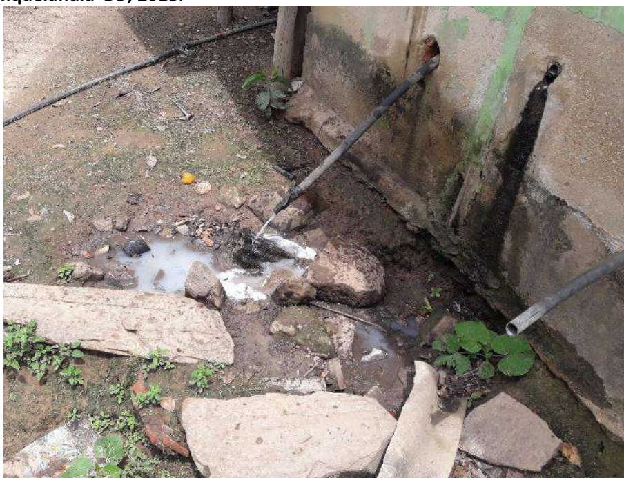
Foto 6.9 – Lançamento e acúmulo de água cinza proveniente do banheiro, da pia da cozinha e/ou do tanque de lavar roupas diretamente no solo do quintal próximo aos domicílios, na Comunidade Rio Vermelho, Niquelândia-GO, 2018.
