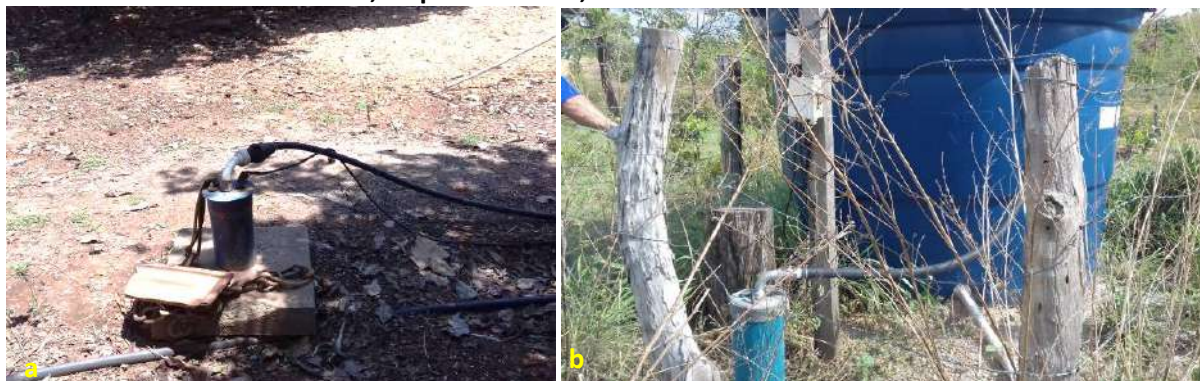
Foto 6.4 – Poços tubulares profundos, com ausência de cerca (a) e cercado com arame farpado (b), na Comunidade Rio Vermelho, Niquelândia-GO, 2018.
