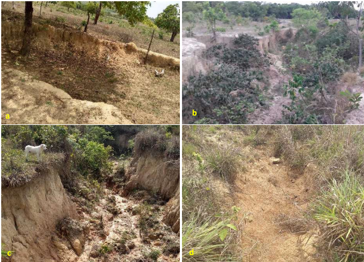
Foto 6.24 – Processos erosivos em lotes da Comunidade Rio Vermelho, Niquelândia-GO, 2018.
