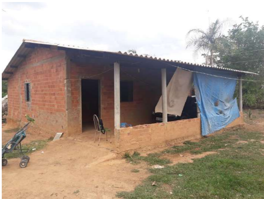
Foto 4.17 – Cobertura de fibrocimento, identificada na Comunidade Rio Vermelho, Niquelândia-GO, 2018.
