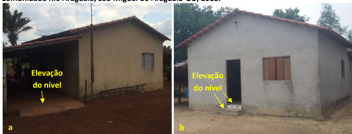
Foto 6.15 – Dispositivo de prevenção dos danos provocados pelas águas em residências da Comunidade Rio Araguaia, São Miguel do Araguaia-GO, 2018.
