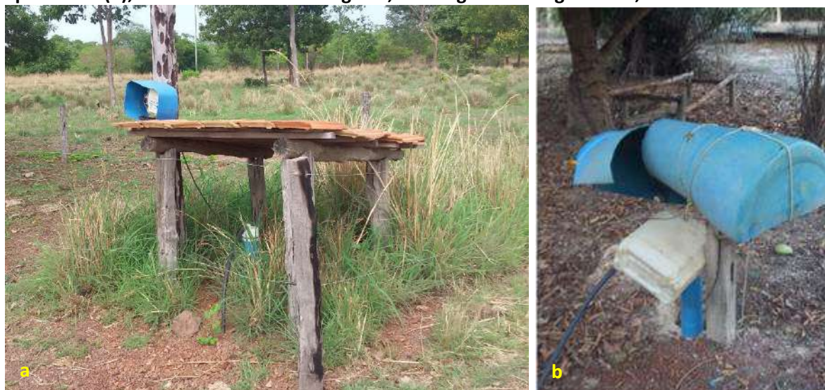
Foto 6.2 – Poço tubular raso abrigado em estrutura de madeira coberta por telhas (a) e em estrutura improvisada (b), na Comunidade Rio Araguaia, São Miguel do Araguaia-GO, 2018.
