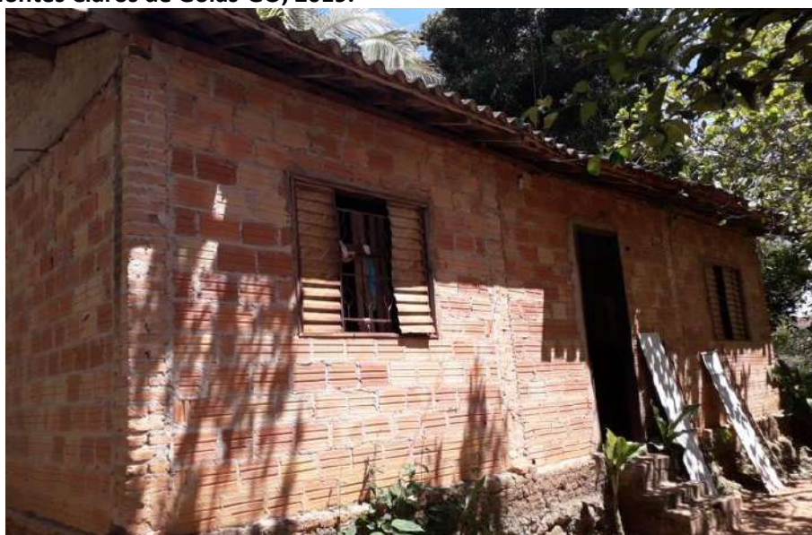
Foto 4.9 – Habitação construída de alvenaria sem reboco, identificada na Comunidade Registro do Araguaia, Montes Claros de Goiás-GO, 2019.
