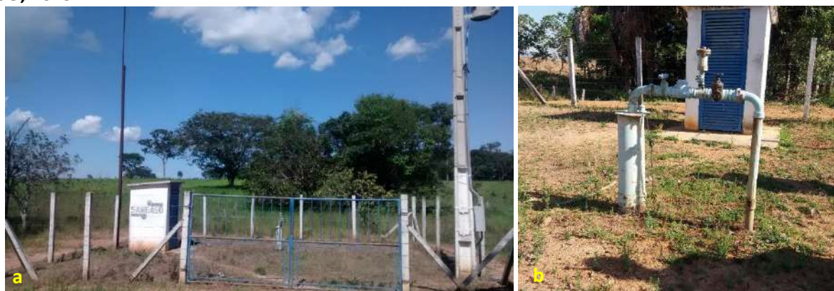
Foto 6.2 – Detalhe do poço tubular profundo com a casa de força (a) e a área de captação do Sistema de Abastecimento de Água cercada na Comunidade Registro do Araguaia, Montes Claros de Goiás-GO, 2019.
