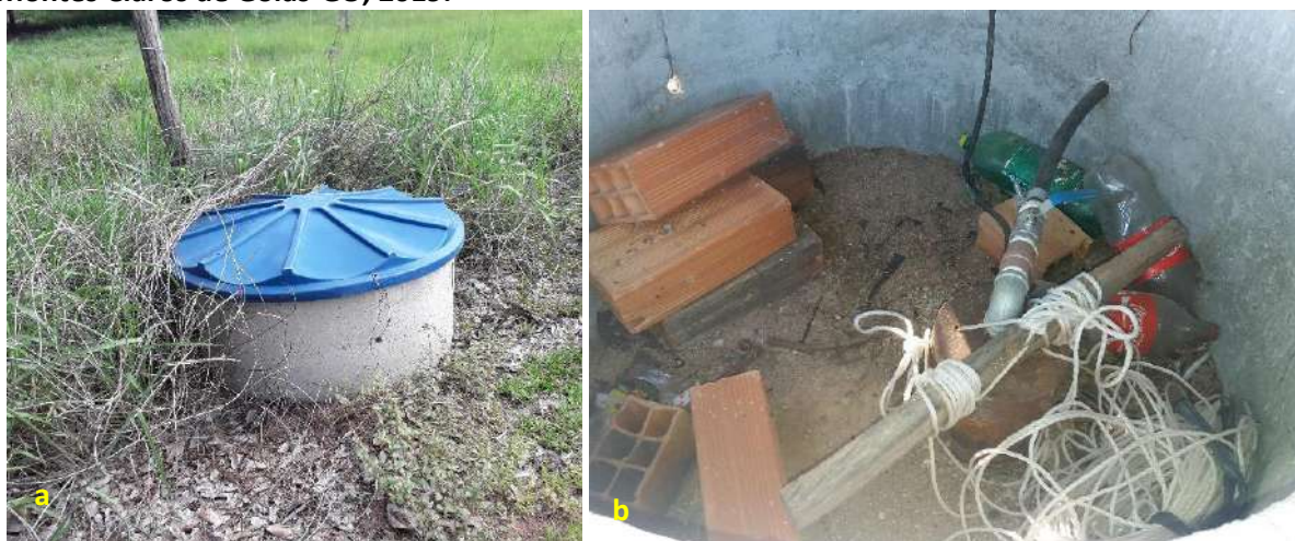
Foto 6.6 – Poço tubular profundo protegido por anel de concreto e tampa de polietileno (a) e resíduos presentes no interior da estrutura de proteção na Comunidade Registro do Araguaia, Montes Claros de Goiás-GO, 2019.
