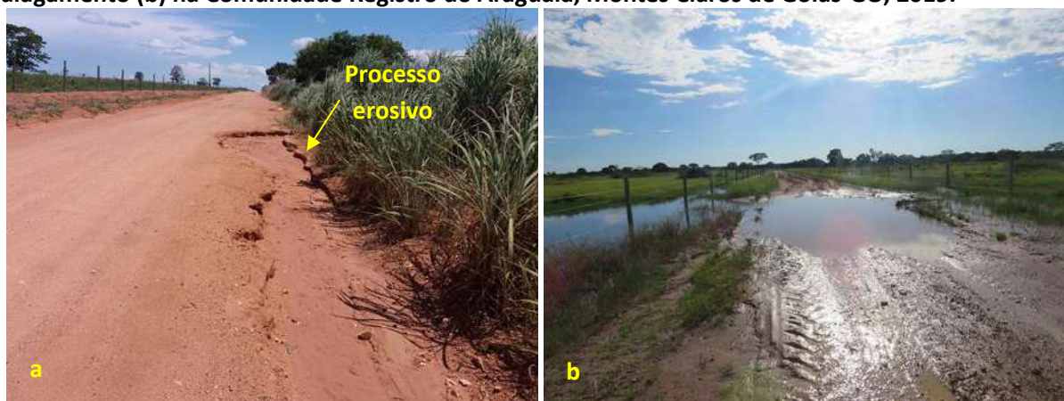
Foto 6.20 – Situação da drenagem pluvial na via de acesso: processo erosivo (a) e ponto de alagamento (b) na Comunidade Registro do Araguaia, Montes Claros de Goiás-GO, 2019.
