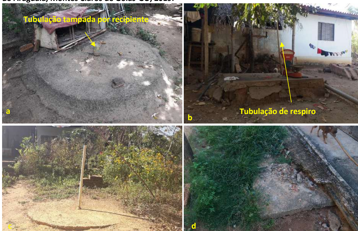
Foto 6.9 – Situações construtivas das fossas negras/rudimentares, com tampa de concreto e com tubulação de respiro (a), (b) e (c) e fossa séptica sem tubulação de respiro (d) Comunidade Registro do Araguaia, Montes Claros de Goiás-GO, 2019.
