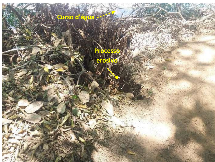
Foto 6.27 – Processo erosivo em lote da Comunidade Registro do Araguaia, Montes Claros de Goiás-GO, 2019.
