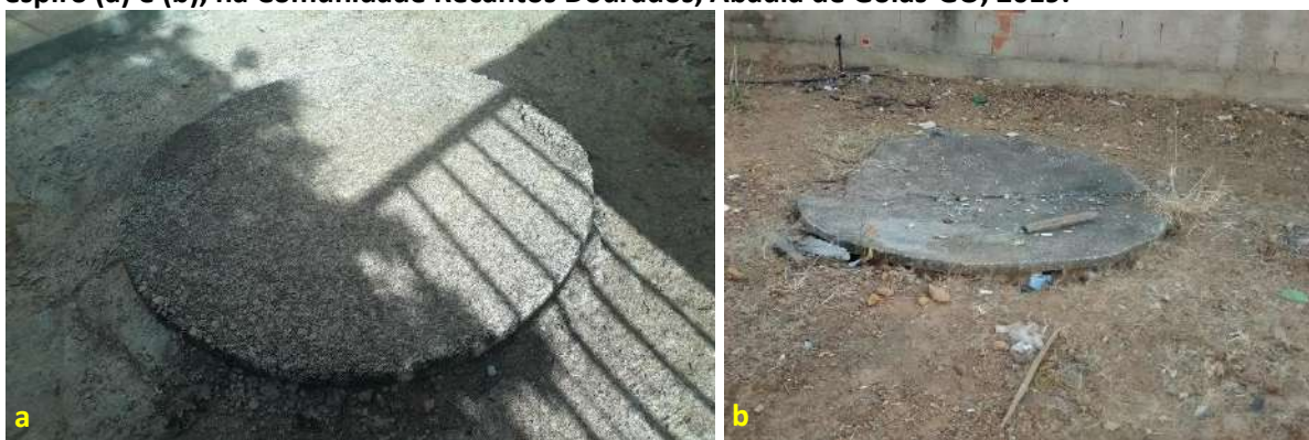
Foto 6.4 – Situações construtivas das fossas sépticas, com tampa de concreto e sem tubulação de respiro (a) e (b), na Comunidade Recantos Dourados, Abadia de Goiás-GO, 2019.
