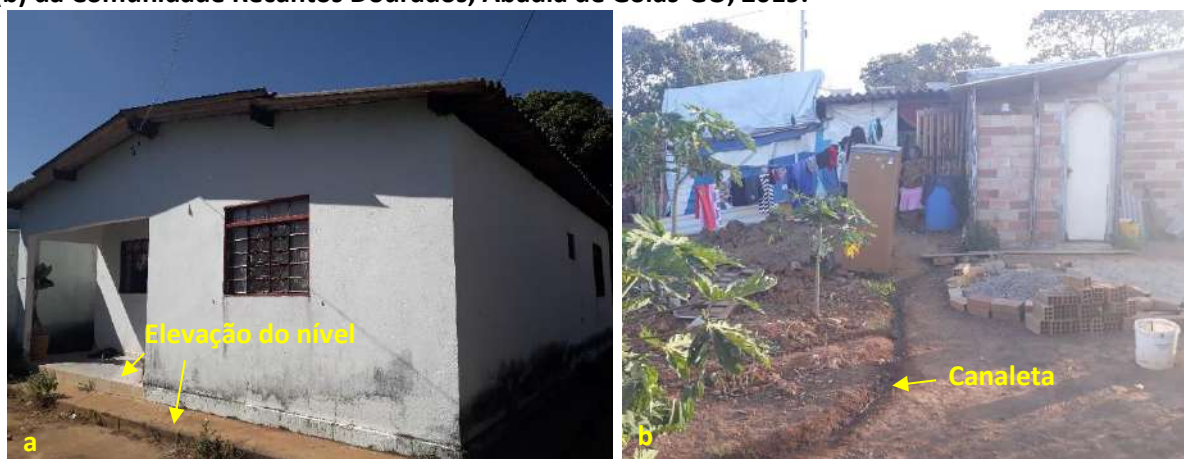
Foto 6.13 – Dispositivos de prevenção dos danos provocados pelas águas em residência (a) e em lote (b) da Comunidade Recantos Dourados, Abadia de Goiás-GO, 2019.
