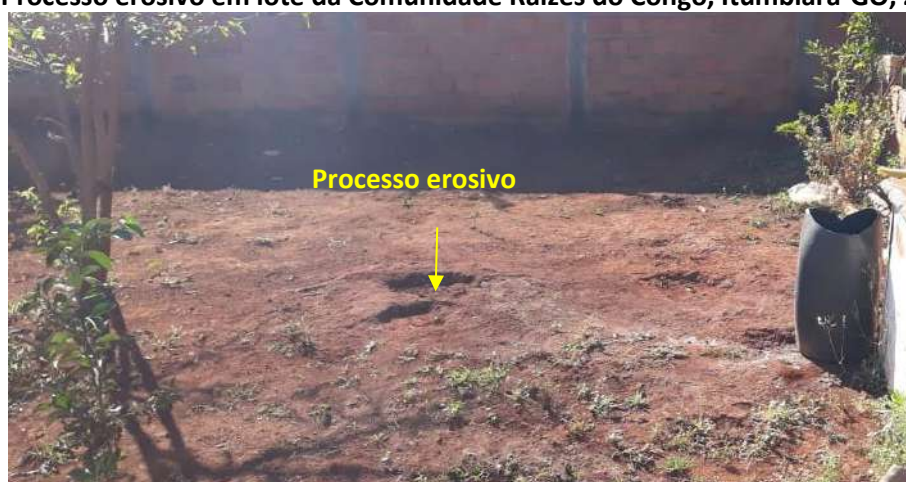
Foto 6.11 – Processo erosivo em lote da Comunidade Raízes do Congo, Itumbiara-GO, 2019.
